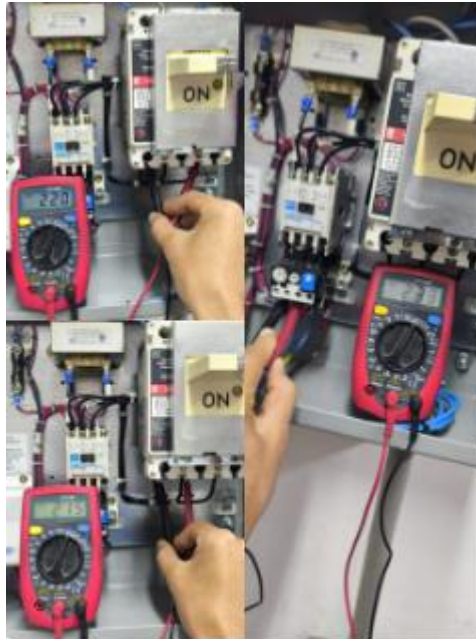
Voltajes de salida bomba jockey en operación
