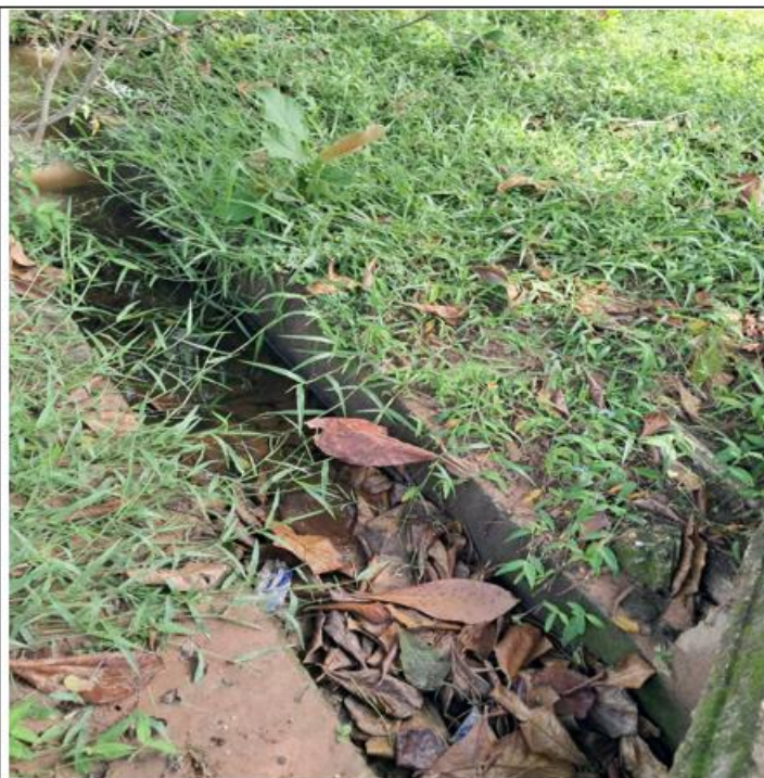
Antes de la actividad de limpieza y retiro de material vegetal de canaleta para aguas lluvias
