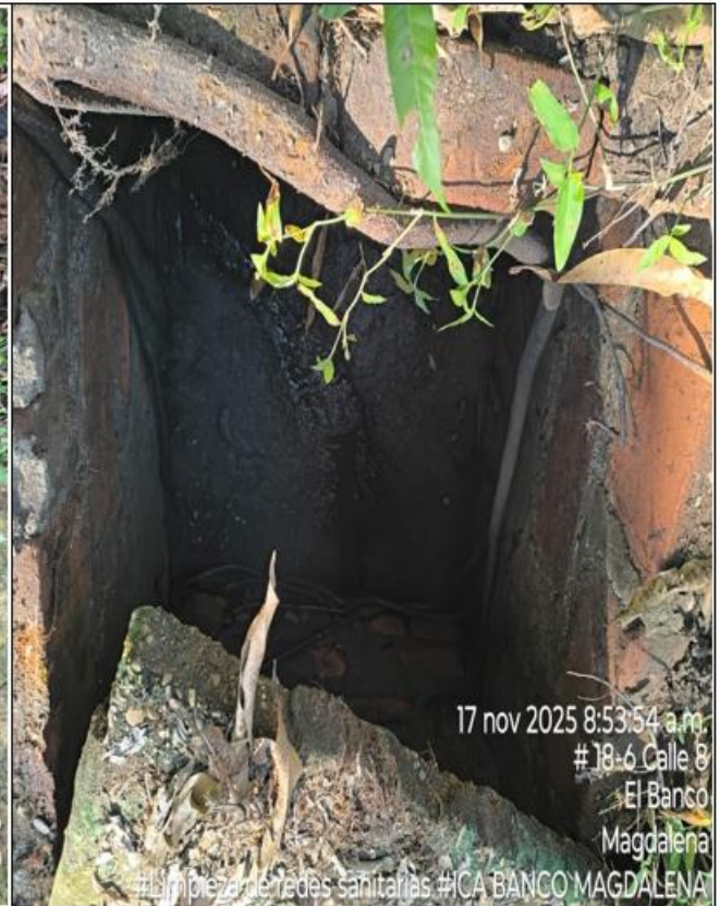
Después de la actividad de succión y sondeo se observa el registro limpio y sin obstrucciones, se retira toda el agua residual y los lodos.
