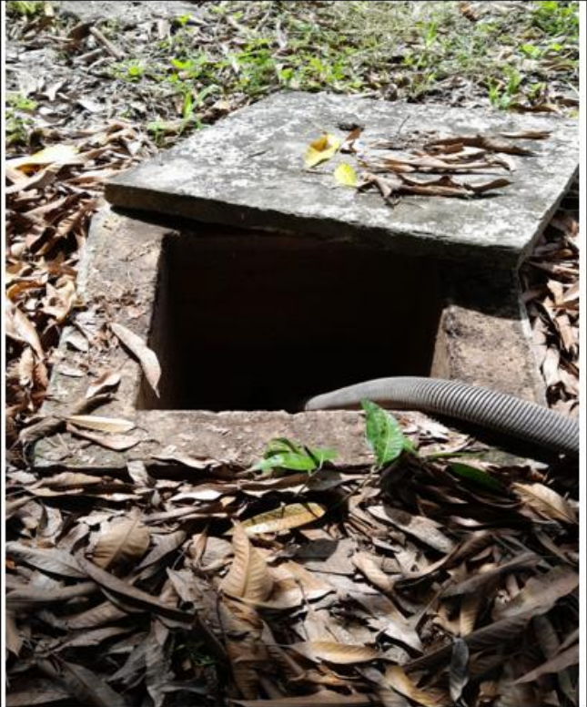
Durante la ejecución de la succión y sondeo de la fosa séptica.
