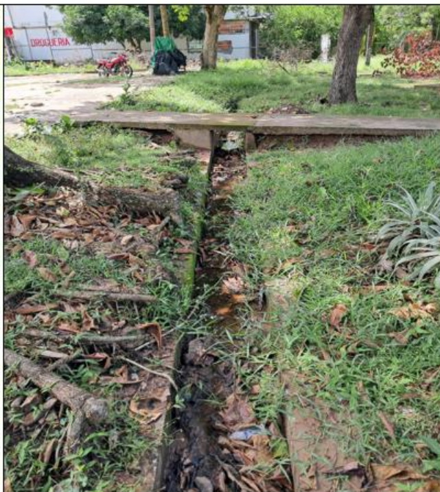
Antes de la actividad de limpieza y retiro de material vegetal de canaleta para aguas lluvias
