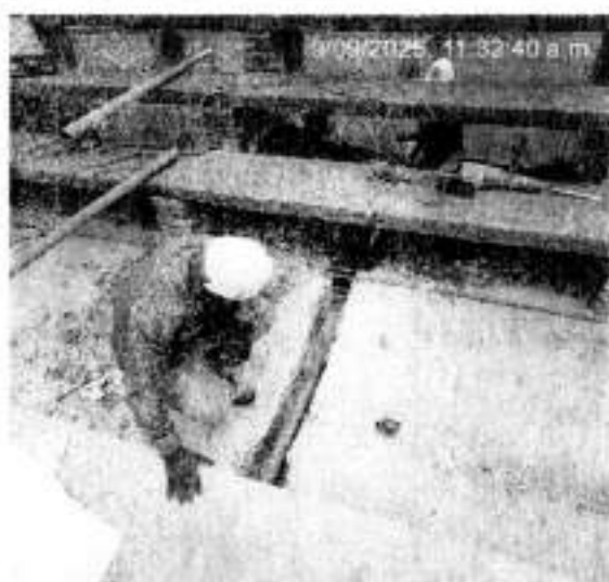
PRD PADEL 12-091 - ACTIVIDADES ELECTRICAS
