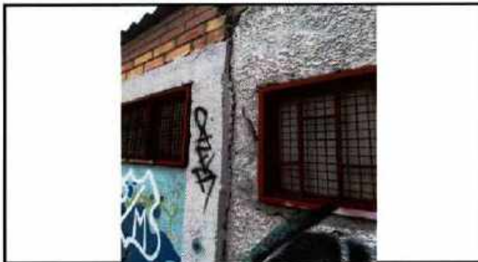
EVIDENCIA MURO SUELO RIESGO COLAPSO
