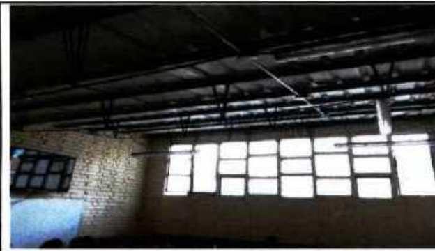
CONEXIONES ELÉCTRICAS PARA ILUMINACIÓN
