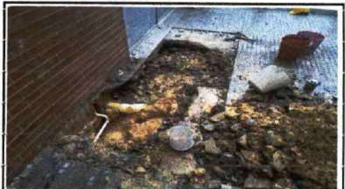
SE EVIDENCIA TUBERIA DE AGUA POTA.
