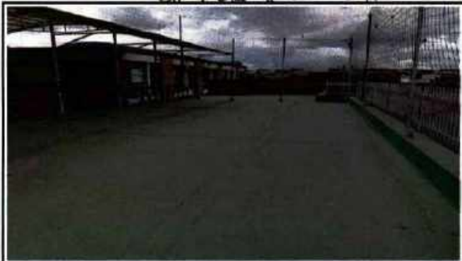
Verificación de Filtracm.
