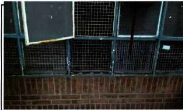
VERIFICACION HUMEDADES Y GOTERAS
