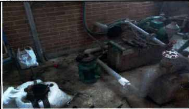
REVISIÓN EQUIPOS HIDRONEUMÁTICOS
