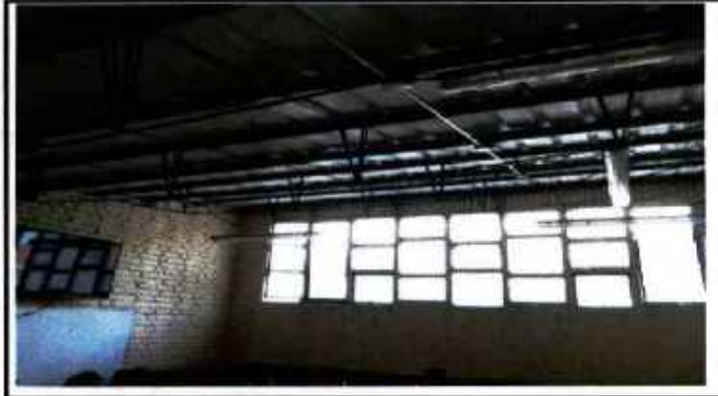
RETIPO DE ILUMINACIÓN EXISTENTE
