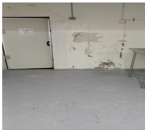
uros con acabado en mal estado
