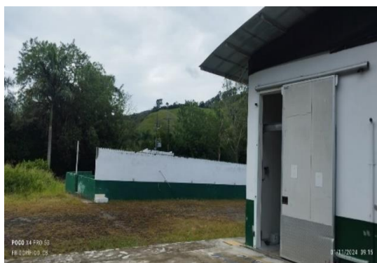
Puertas de cuartos fríos en mal estado
