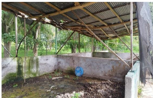
Estercolero en mal estado
