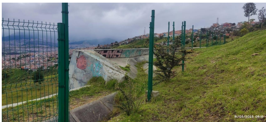
Fotos # 9, 10 y 11 Falta la malla de protección del muro de contención, zona peligrosa hay un abismo
