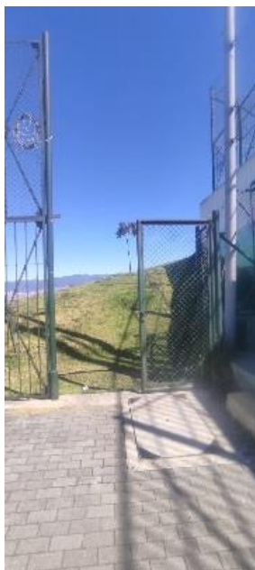
Foto # 8 Puerta de la cancha # 1 está deteriorada
