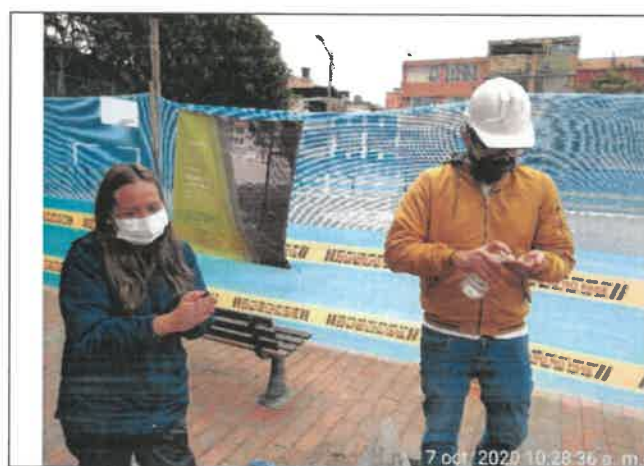
FOTO No. 137. Se revisó y verifico el cumplimiento del plan de manejo de tránsito (PMT), parque. URBANIZACIÓN LA ESTANCIA. 19-149 el cual no se cumple.
