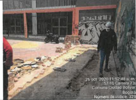
FOTO No 84. La interventoría ARQUITECTURA URBANA LTDA. Indica las directrices y es necesario ampliar el área de desmonte del adoquín existente (32,5m 2 ) para garantizar la estabilidad del terreno y no genere más hundimientos.
