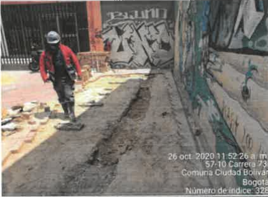
FOTO No 83. La interventoría ARQUITECTURA URBANA LTDA. Evidencia que existe un fallo en la estructura del piso existente, la cual el contratista debe subsanar. Se deja evidenciado en la bitácora de obra. En la primera semana de octubre
