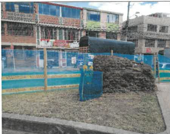
FOTO No. 113. Se revisó y verifico el acopio de material de céspedón para disposición final sin el respectivo cerramiento y señalización, parque. URBANIZACIÓN LA ESTANCIA. 19-039
