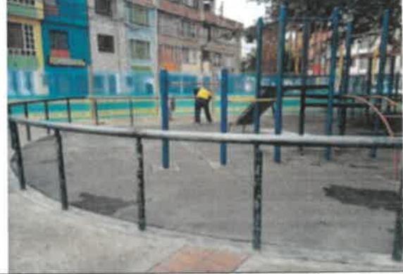
FOTO No 48. La interventoría ARQUITECTURA URBANA LTDA. Revisa y verifica que el contratista CONSORCIO OPORTO realice el proceso de mantenimiento del juego infantil existente MÓDULO M3, con lija y aplicación de anticorrosivo. Debido a que el contratista no ha soportado las certificaciones de calidad de los componentes de la baranda ni de las bandejas cuadradas del juego infantil existente, y además surge la inquietud que la savia del árbol existente afectará la pintura de la baranda, esta actividad se suspende, y se trasladará la inquietud a la supervisión.
