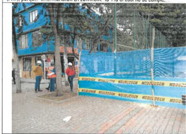
FOTO No. 139. Se revisó y verifico el cumplimiento del PMT, parque. URBANIZACIÓN LA ESTANCIA. 19-149 el cual no se cumplió
