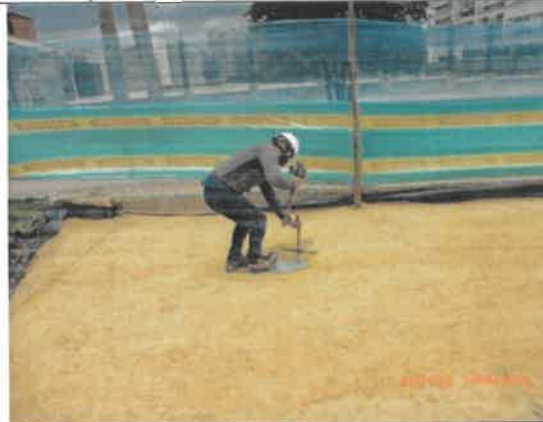
FOTO No 72. La interventoría ARQUITECTURA URBANA LTDA. Revisa y verifica que con la toma de densidades NO CUMPLE con los requisitos de compactación de la subbase en el área de biosaludables. La interventoría no avala esta actividad y deberá nuevamente compactar y volver a tomar densidades. Los resultados en uno de los puntos corresponden a los siguientes valores: Compactación: 94,80 %, lineamiento de PROCTOR: 95%. Humedad: 6,8% óptimo: 9%. Se deja en bitácora de obra la recomendación de volver a tomar la densidad.
