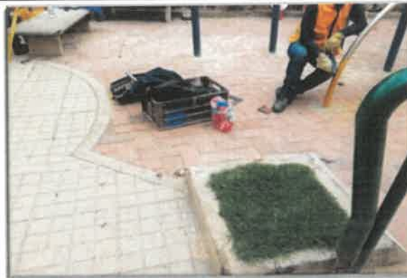
FOTO No 8. La interventoría ARQUITECTURA URBANA LTDA. Revisa y verifica que dentro del parque existen elementos que interfieren con la libre circulación, como es una jardinera que actúa como obstáculo en la movilidad. Se requiere demolerla. Y se deja la evidencia en el libro de actas.
