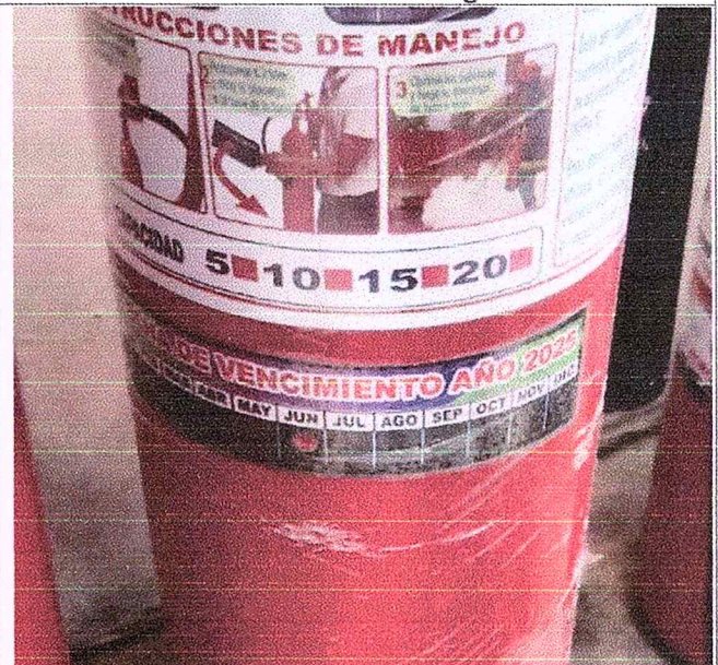
Fecha de caducidad de la recarga del extintor
