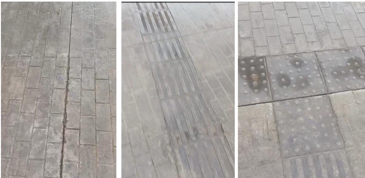
Juntas discontinuas y desportilladas, losetas con superficies lisas o con relieves insuficientes
