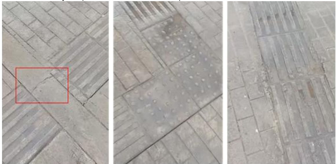
Confinamientos agrietados, losetas con superficies lisas o con relieves insuficientes
