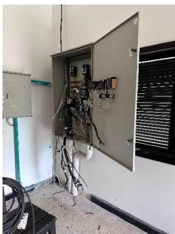
Foto 1: Panorámica mantenimiento Micro Central Hidroeléctrica.
