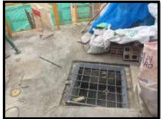
CAJA DE INSPECCIÓN
