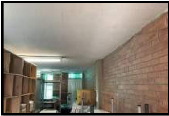
REVISION DE FILTRACIONES EN SALONES INFERIORES
