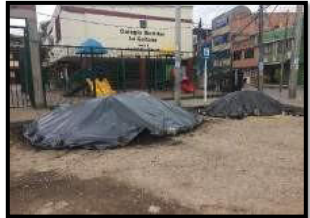
CUBRIMIENTO DE MATERIAL ESCOMBRO Y
