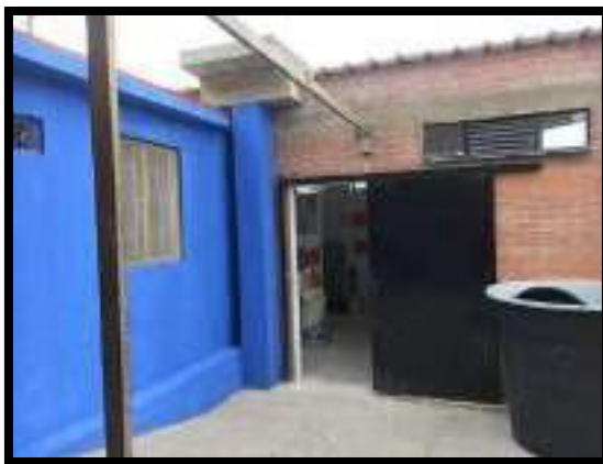
PUERTA METALICA PARA INGRESO A BAÑO
