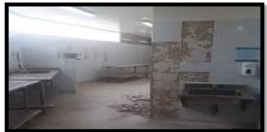
DESMONTE DE ENCHAPES FISURADOS
