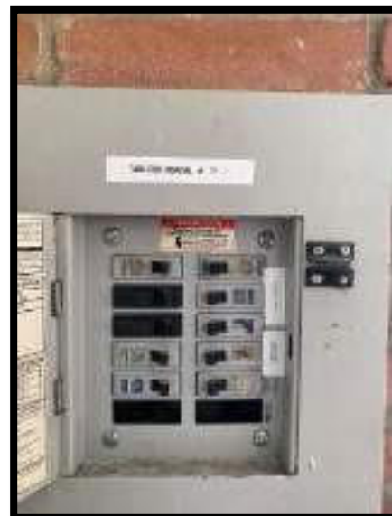
MARQUILLADO EN TABLERO ELÉCTRICO
