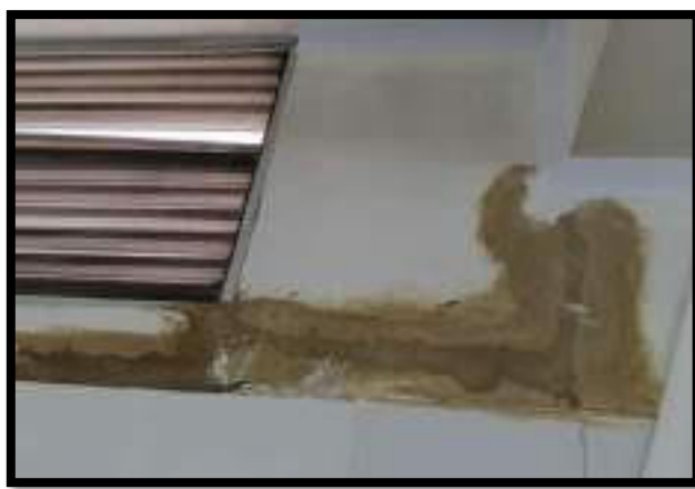
DILATACIÓN DE FISURA EN MURO
