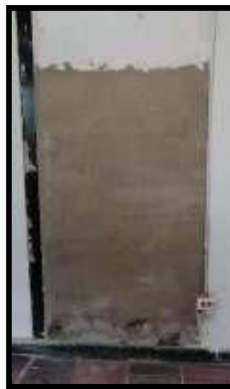
RESANES EN ZONA DE FISURAS
