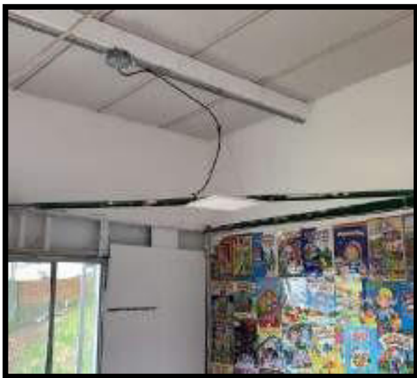
MODIFICACIÓN DE ALTURA DE LAMPARAS
