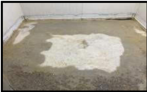
ESTADO ACTUAL DE PLACA CUARTO FRIO
