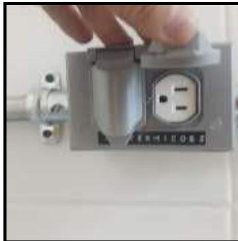
MARQUILLADO DE SALIDAS ELECTRICAS
