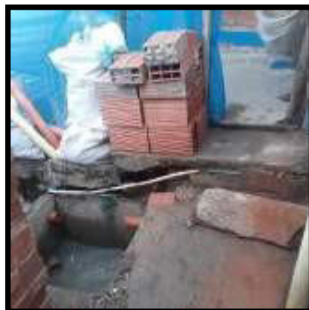
CAJA DE INSPECCION
