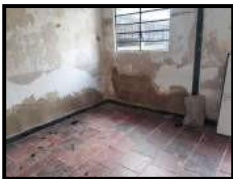
RESANES EN ZONA DE FISURAS
