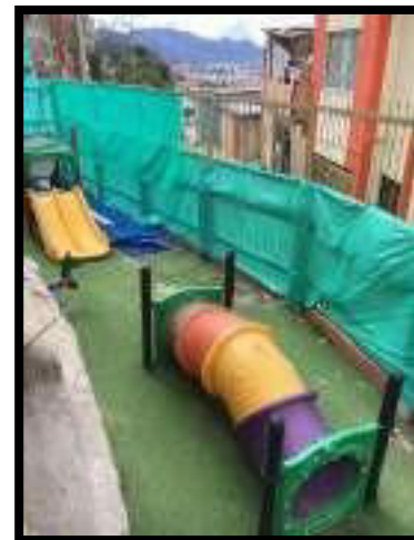
CERRAMIENTO PERIMETRAL EN LONA
