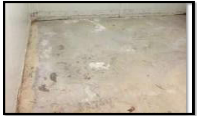
ESTADO ACTUAL DE PLACA CUARTO FRIO
