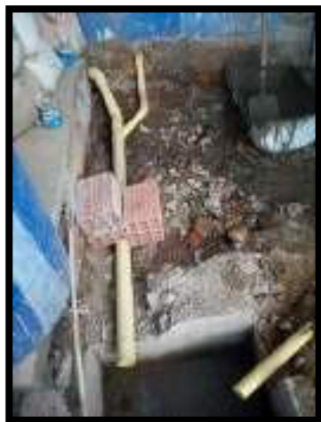
TUBERIA HIDROSANITARIA Y CAJA DE INSPECCIÓN
