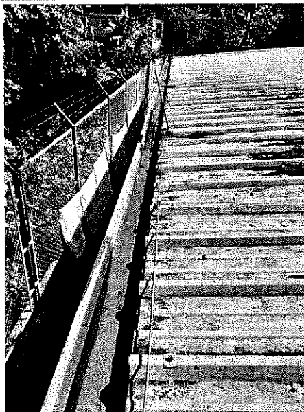
REGULAR ESTADO CANALES Y CUBIERTA
