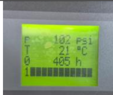
FIGURA 2 HORAS DE TRABAJO COMPRESOR KAESER DE TORNILLO AIRTOWER 7.5C
