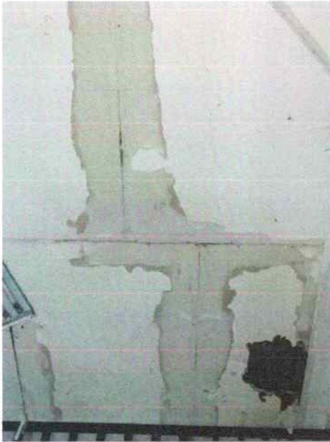
Cielo raso (Antes)
