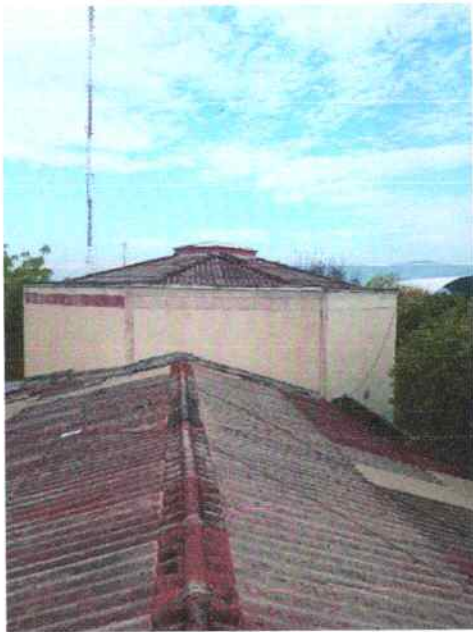
Caballote de la cubierta en Eternit (Antes)
