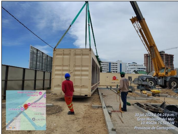
Ubicación de contenedores de oficinas
