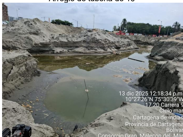
Inundación y retraso por daño en tubería de agua
