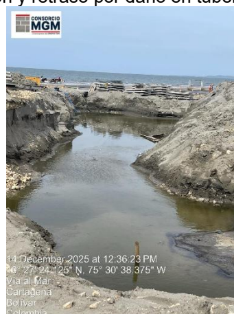
Inundación y retraso por daño en tubería de agua
