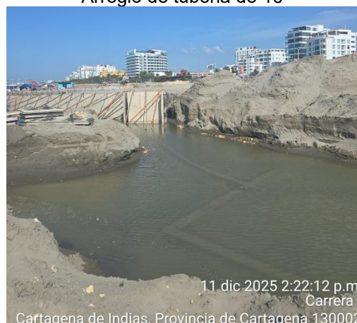
Inundación y retraso por daño en tubería de agua
