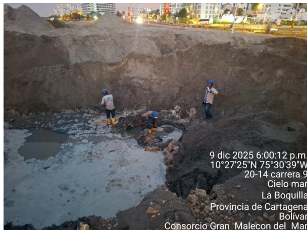
Daño de tubería GRP 16"
