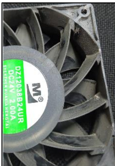
Ilustración 103 Estado de los ventiladores de la ups segundo piso
