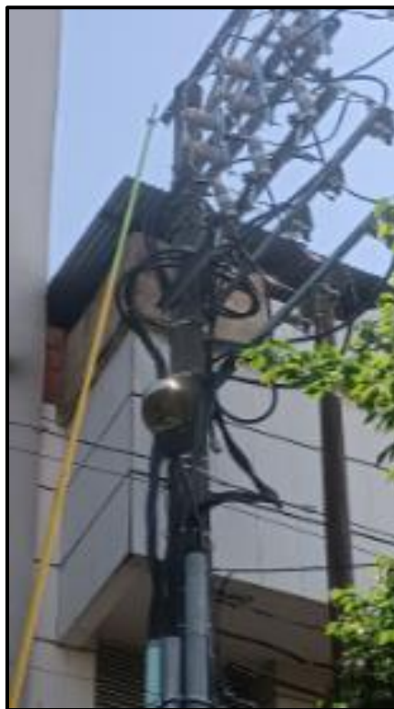
Ilustración 114 Interrupción de la energía de la red de alta tensión del edificio de la contraloría de la república
