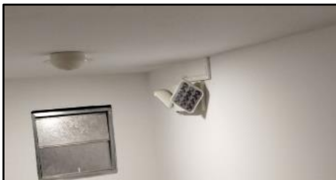
Ilustración 81 Lámpara de emergencia a intervenir primer piso
