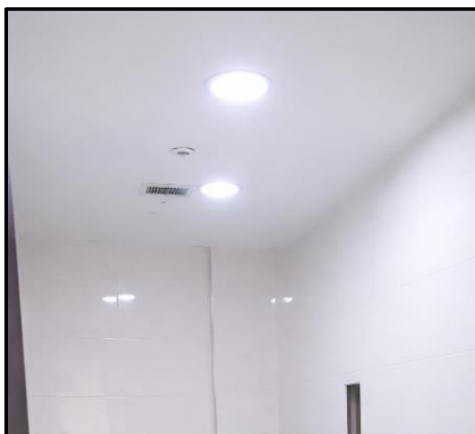
Ilustración 67 Luminarias instaladas en cafetería
