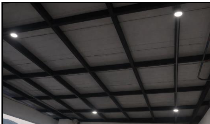
Ilustración 78 Luminarias de sobreponer en mal estado en terraza
