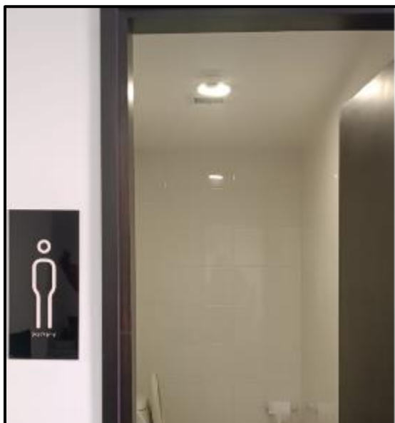
Ilustración 65 luminarias a intervenir en zona de baños
