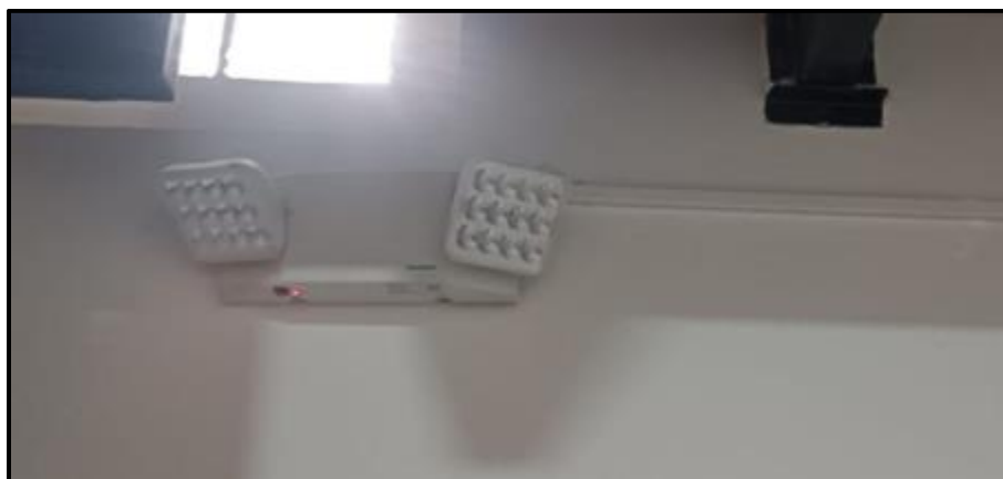
Ilustración 82 Lámpara de emergencia a intervenir segundo piso
