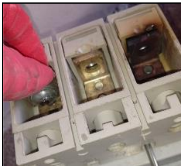
Ilustración 112 Presencia de puntos calientes en terminales de conexiones al totalizador
