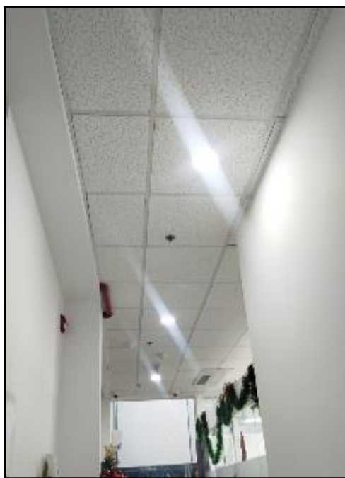
Ilustración 54 Luminarias instaladas en zona de pasillo
