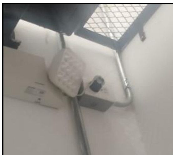
Ilustración 95 Puntos de conexión para regulación de carga y energía de la lámpara de emergencia piso 6
