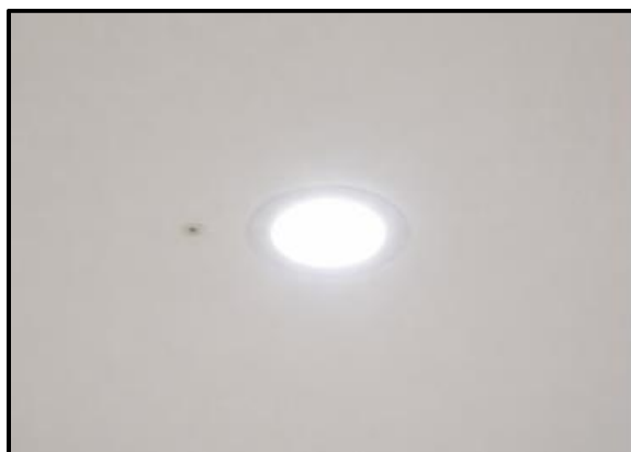
Ilustración 62 Luminaria instalada en la zona de grupo de responsabilidad fiscal
