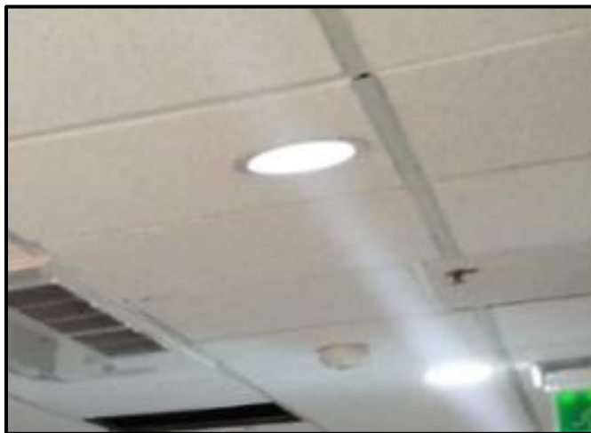
Ilustración 64 Luminarias a intervenir en pasillo de cobro coactivo
