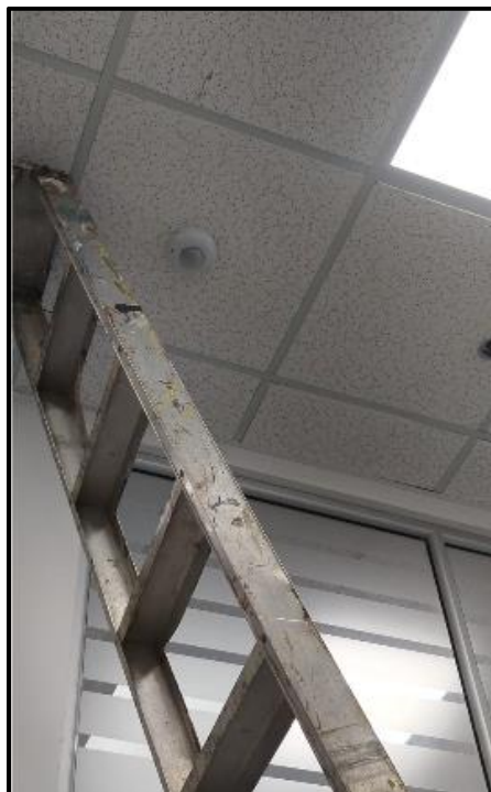
Ilustración 16 Sensor suministrado e instalado en zona de coordinación de responsabilidad fiscal
