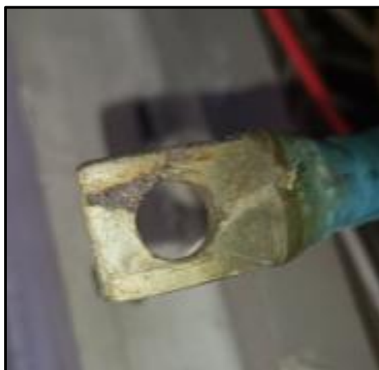
Ilustración 111 terminales quemadas a los puertos de conexiones internas del totalizador
