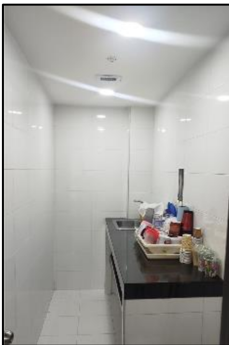
Ilustración 73 Luminaria instaladas en zona de cafetería
