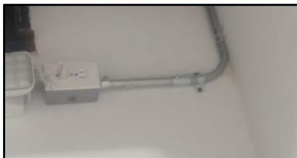
Ilustración 92 Puntos de conexión para regulación de carga y energía de la lámpara de emergencia piso 3
