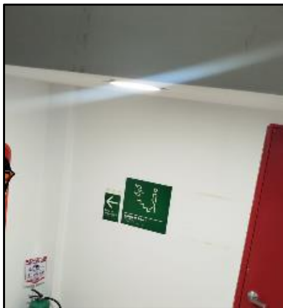
Ilustración 49 Luminaria instalada en las escaleras de emergencia piso 3
