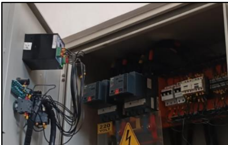
Ilustración 118 Estado de transferencia y conexiones en mal estado
