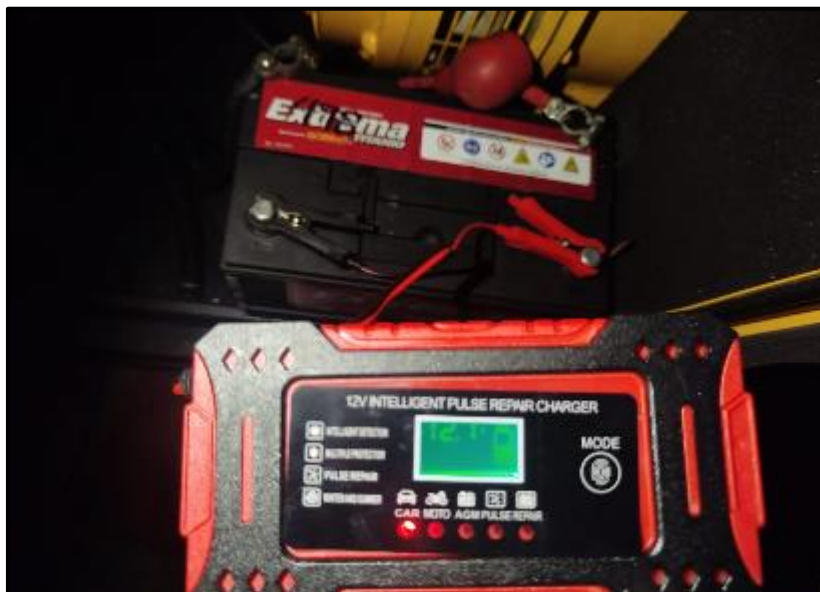
Ilustración 102 Verificación del estado y carga de la batería del generador
