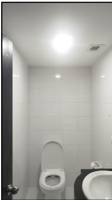
Ilustración 77 Luminaria instalada en baño de damas
