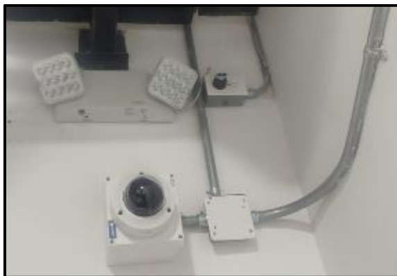
Ilustración 91 Caja de paso para conexiones en tubería metálica piso 2
