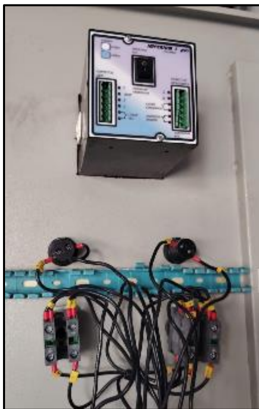
Ilustración 117 Estado de transferencia a cambiar y mal estado del cableado
