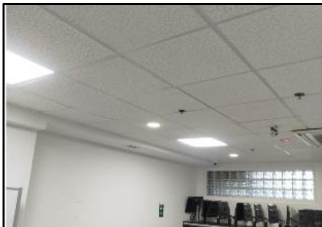
Ilustración 56 Luminarias a intervenir en sala de audiencias
