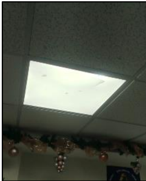
Ilustración 11 Panel fracturado en zona de grupo de responsabilidad fiscal
