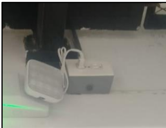
Ilustración 93 Puntos de conexión para regulación de carga y energía de la lámpara de emergencia piso 4
