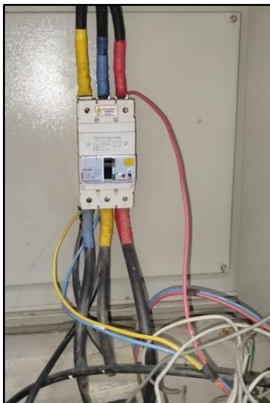
Ilustración 110 Estado y malas conexiones del totalizador de energía
