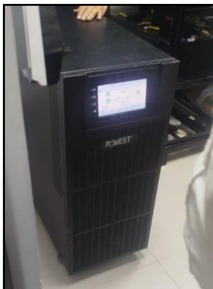
Ilustración 106 Limpieza externa y verificación de la programación de la ups
