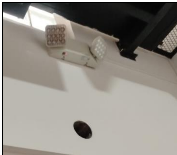
Ilustración 83 Lámpara de emergencia a intervenir tercer piso
