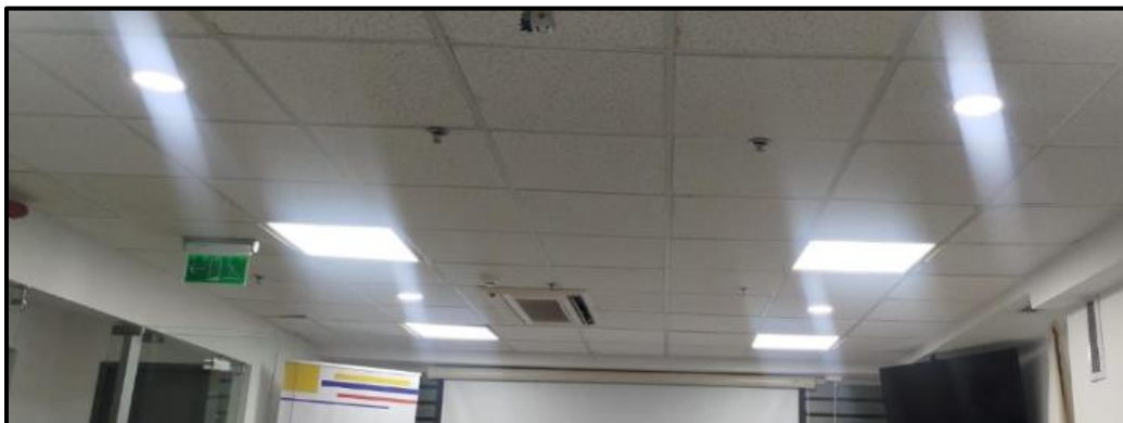
Ilustración 58 Luminarias instaladas en sala de audiencias
