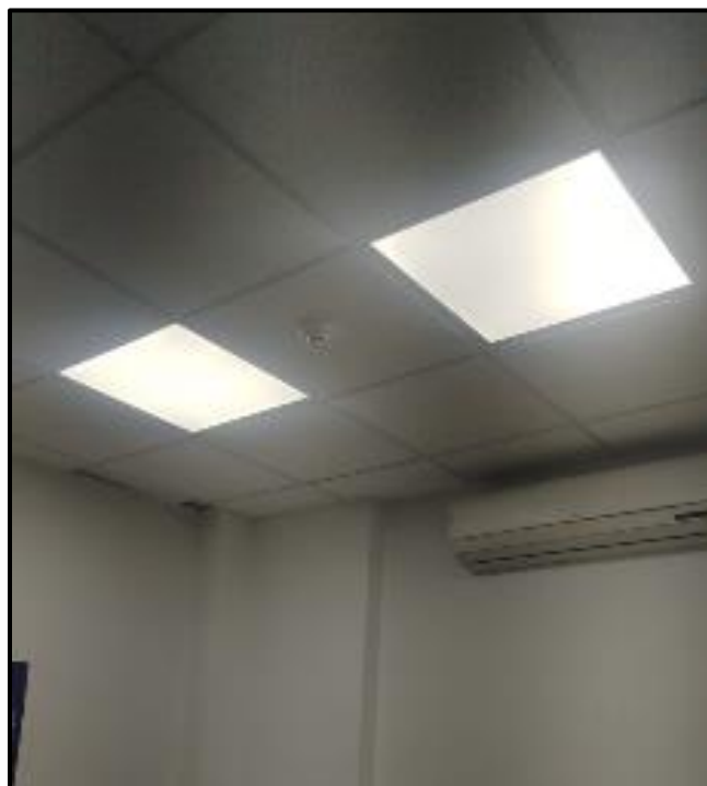
Ilustración 10 Instalación de panel en contraloría provincial
