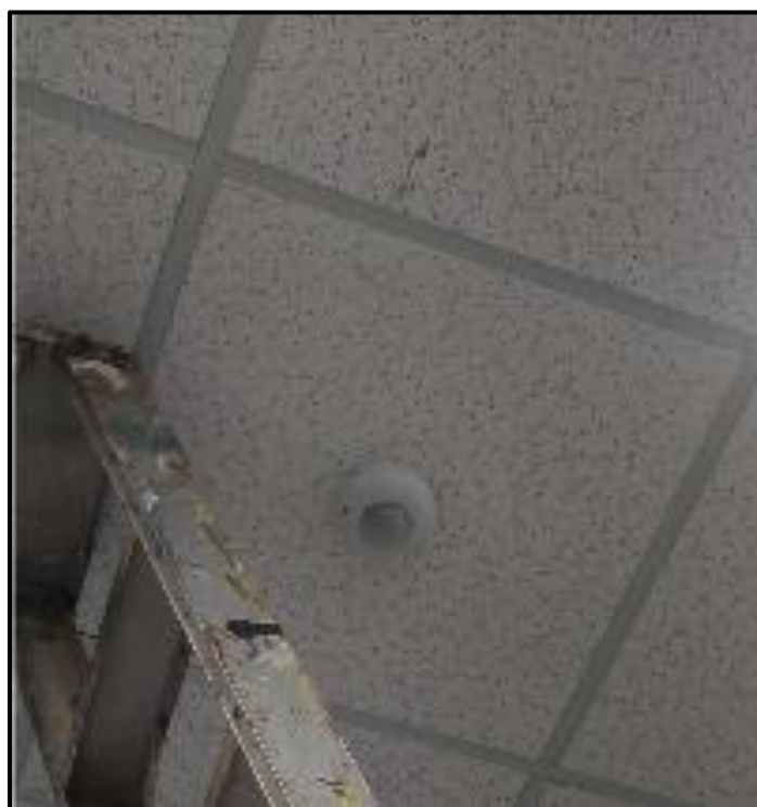
Ilustración 6 Sensor a intervenir en zona de pasillo
