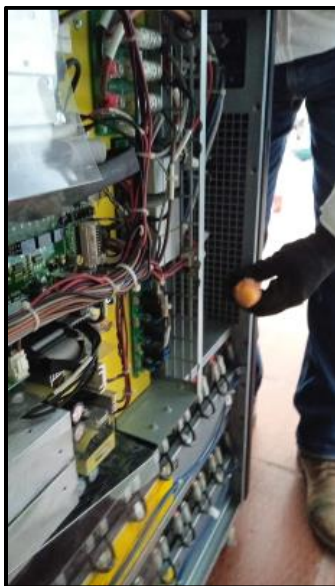
Ilustración 107 Limpieza y ajuste de estructura interna de componentes electrónicos séptimo piso
