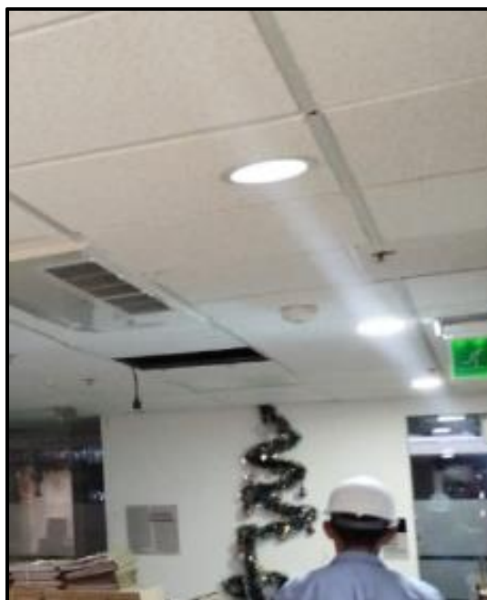
Ilustración 68 Luminarias instaladas en pasillo de cobro coactivo
