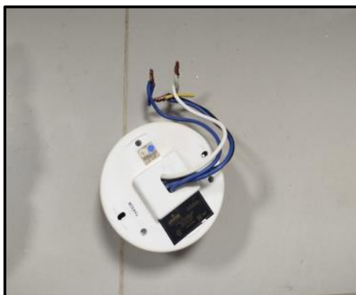
Ilustración 53 Sensor en mal estado y retirado de la zona del pasillo
