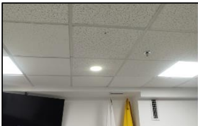
Ilustración 57 Luminarias a intervenir en sala de audiencias
