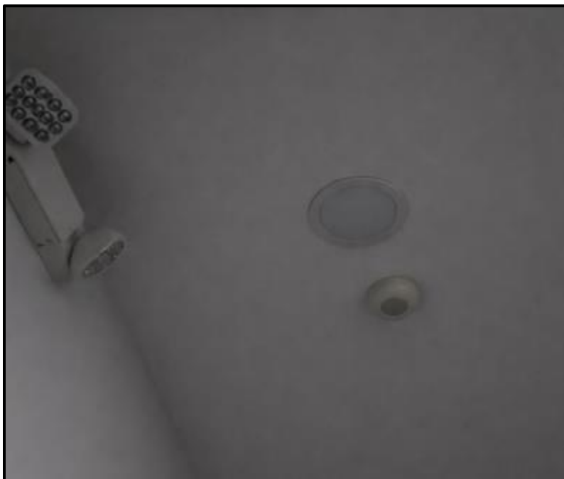
Ilustración 47 Luminaria en mal estado a intervenir con sensor exterior
