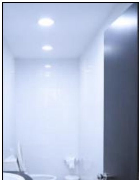
Ilustración 66 Luminarias instaladas en baño de caballeros
