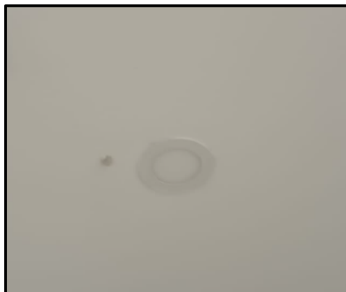
Ilustración 60 luminaria a intervenir en la zona de grupo de responsabilidad fiscal
