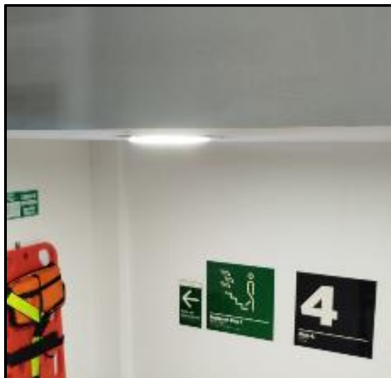
Ilustración 48 Luminaria instalada en las escaleras de emergencia piso 4
