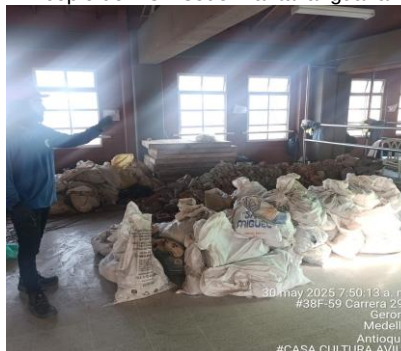
Acopio de RCD sede Casa Cultura Ávila
