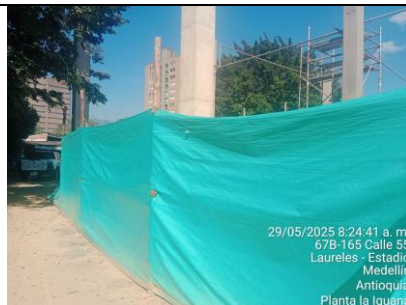
Cerramiento para control de emisiones atmosféricas Sede Planta la Iguana
