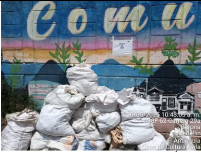
Acopio de RCD sede Casa Cultura Ávila
