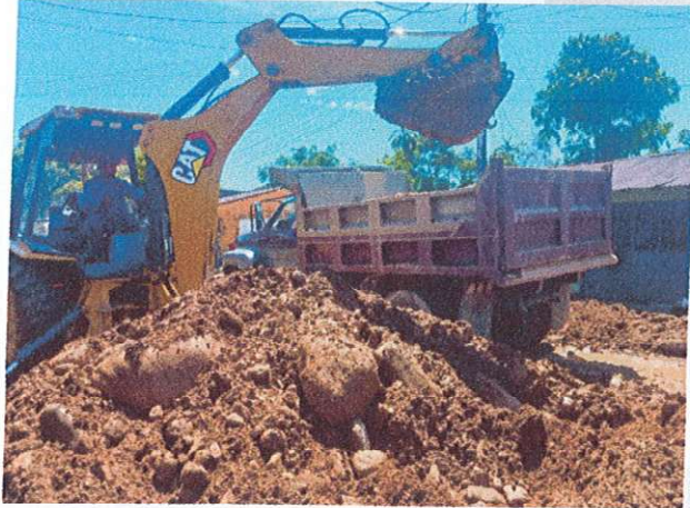
Ilustración 27. imprevistos por sobre excavación
