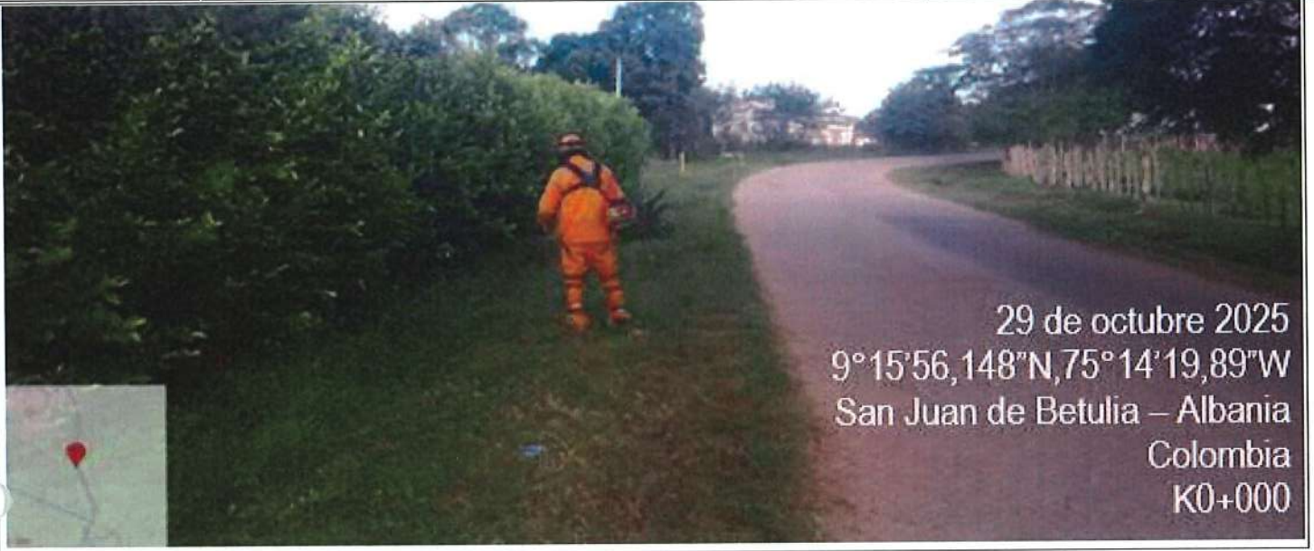
Trabajos de rocería en tramo de Sampues - San benito entre el PR00-PR04
