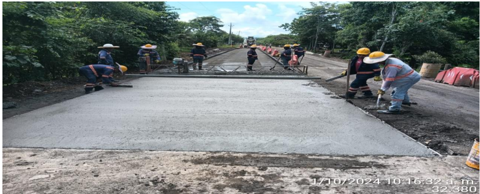
Fundida de pavimento MR40 desde el PR 24+460 hasta el PR 24+530 carril derecho.
