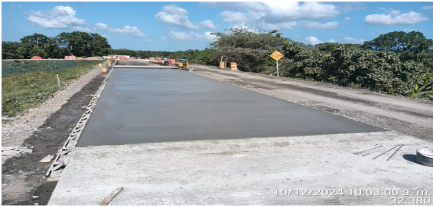
Fundida de pavimento MR40 desde el PR 34+485 a menores carril izquierdo.
