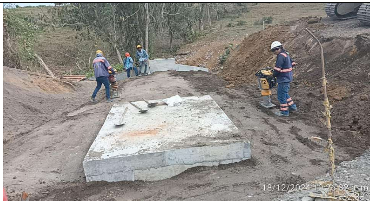
Alcantarilla PR30+220. Lleno en alcantarilla.
