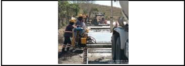
Pavimento MR40 PR 30+235 a mayores en el carril derecho
