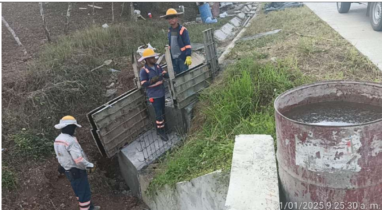
Fundida de dissipador en el PR27+600 margen derecha.
