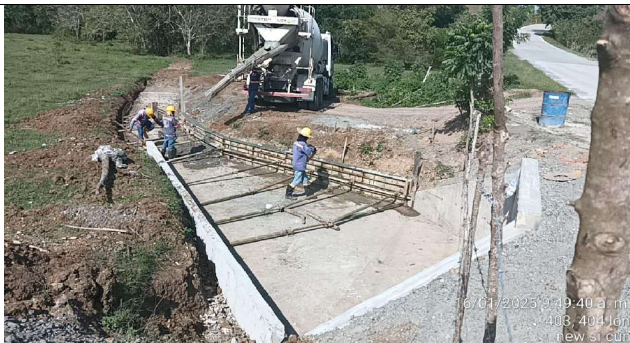
Alcantarilla PR27+075 lado izquierdo. Se funden módulos de descole.
