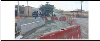
llenos en Alcantarilla del Pr 34+340 lado derecho.
