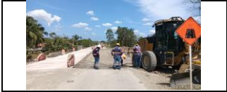
cereo de subbase en el carril derecho del Pr 28+178 a mayores.
