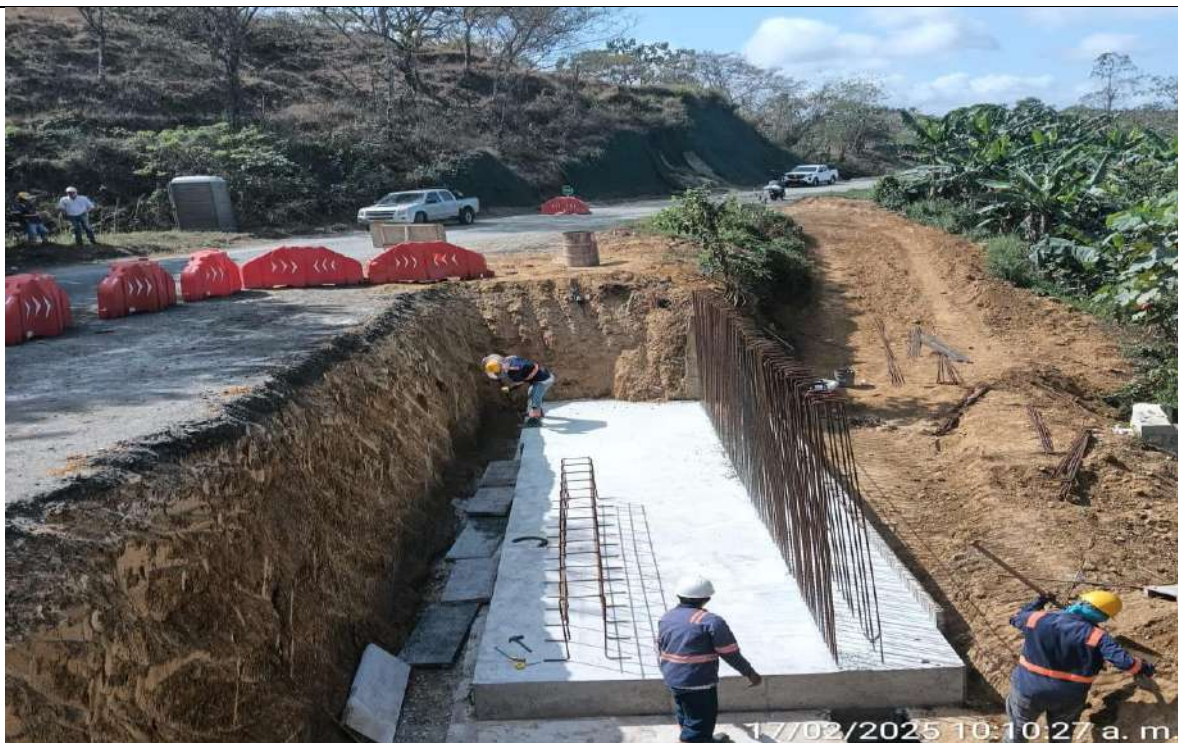
Muro PR46+500 carril izquierdo. Fundida de zarpa.
