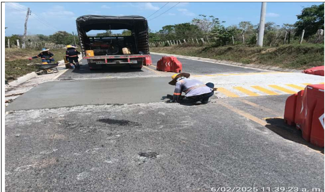
Fundida de resalto pompeyano en el PR18+452 Y PR18+930 carril izquierdo.
