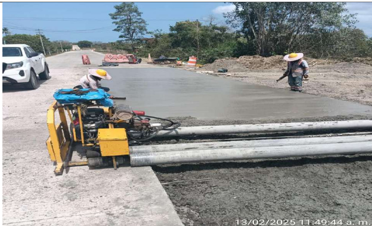
Fundida de pavimento MR-40 del PR28+212 a menores carril derecho.
