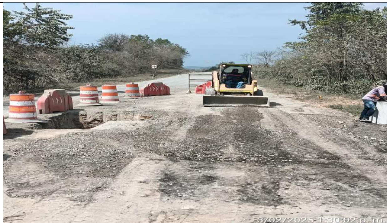
Box Culvert PR32+730. Lleno con material de afirmado.
