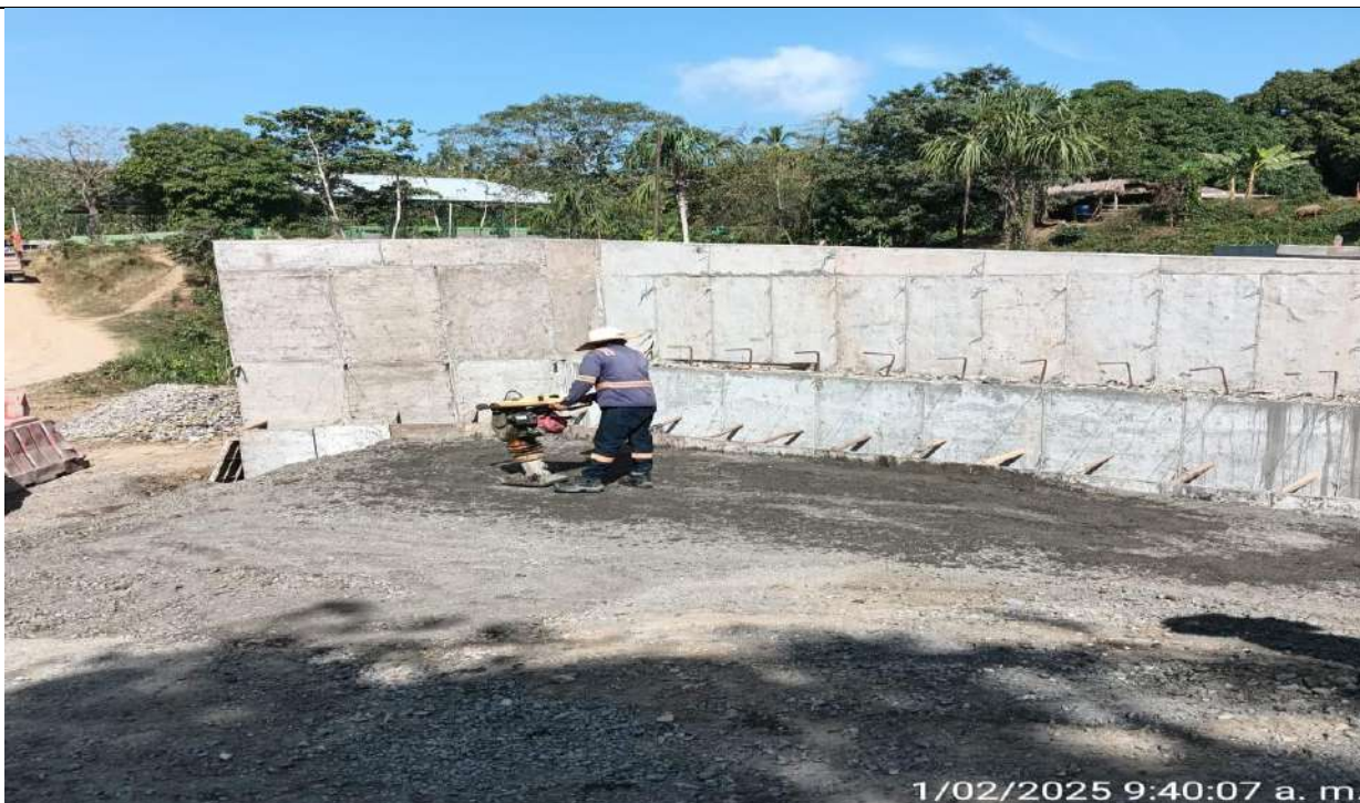
Puente PR45+700. Lleno con material de afirmado en el estribo 1.
