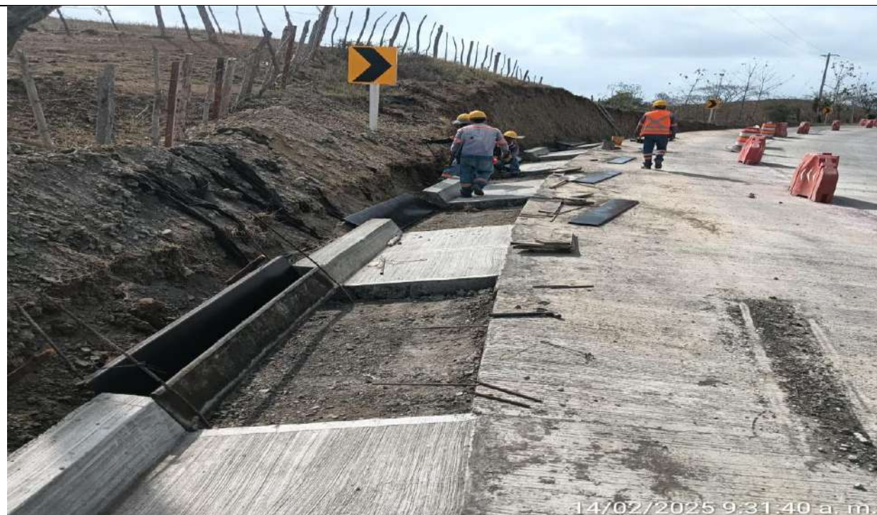
Se funden módulos de cunetas del PR30+030 al PR30+100 lado derecho.
