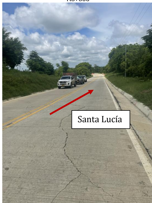
Fotografía 1. Tramo deteriorado sector K8+300 – K8+500
