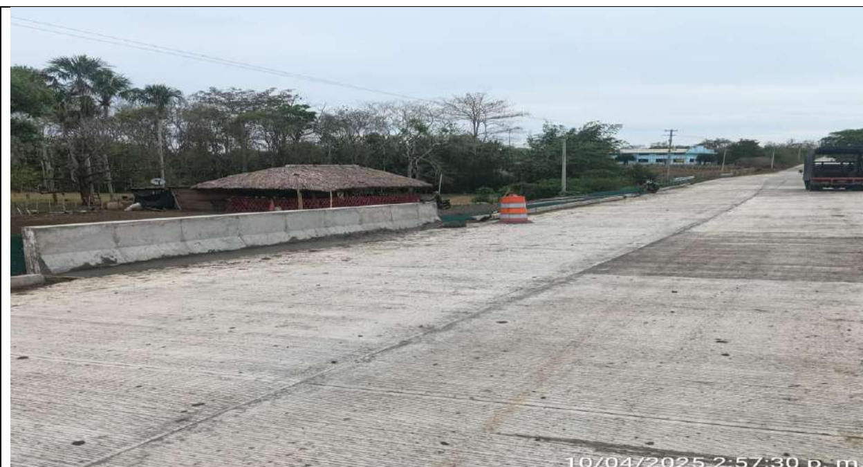
Fundida de sobre ancho en el PR28+500.
