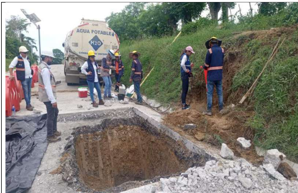
PR 8+925 lado derecho. Ensayo de filtración con anilina.
