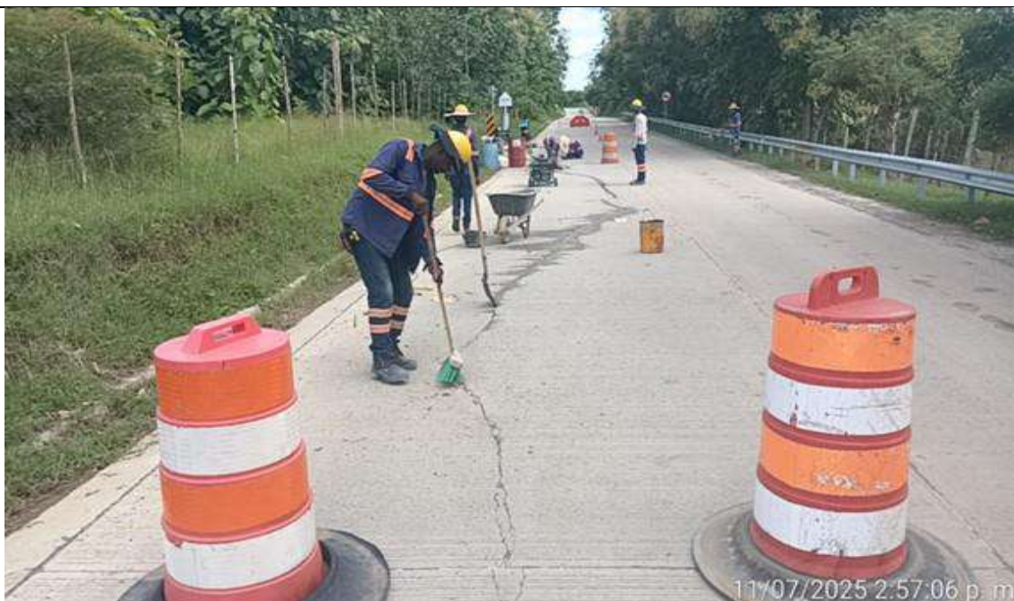
PR 13+540 a mayor lado derecho. Costura y sello en losas de pavimento MR40.
