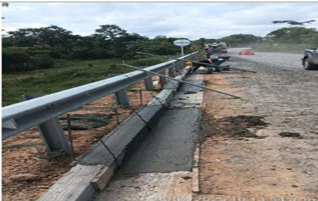
Pr 34+480. Fundida de cunetas.
