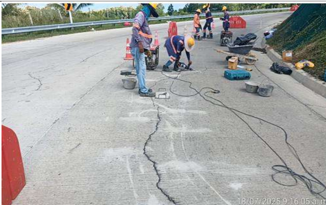
PR 10+600 lado derecho. Costuras losas de pavimento MR40.
