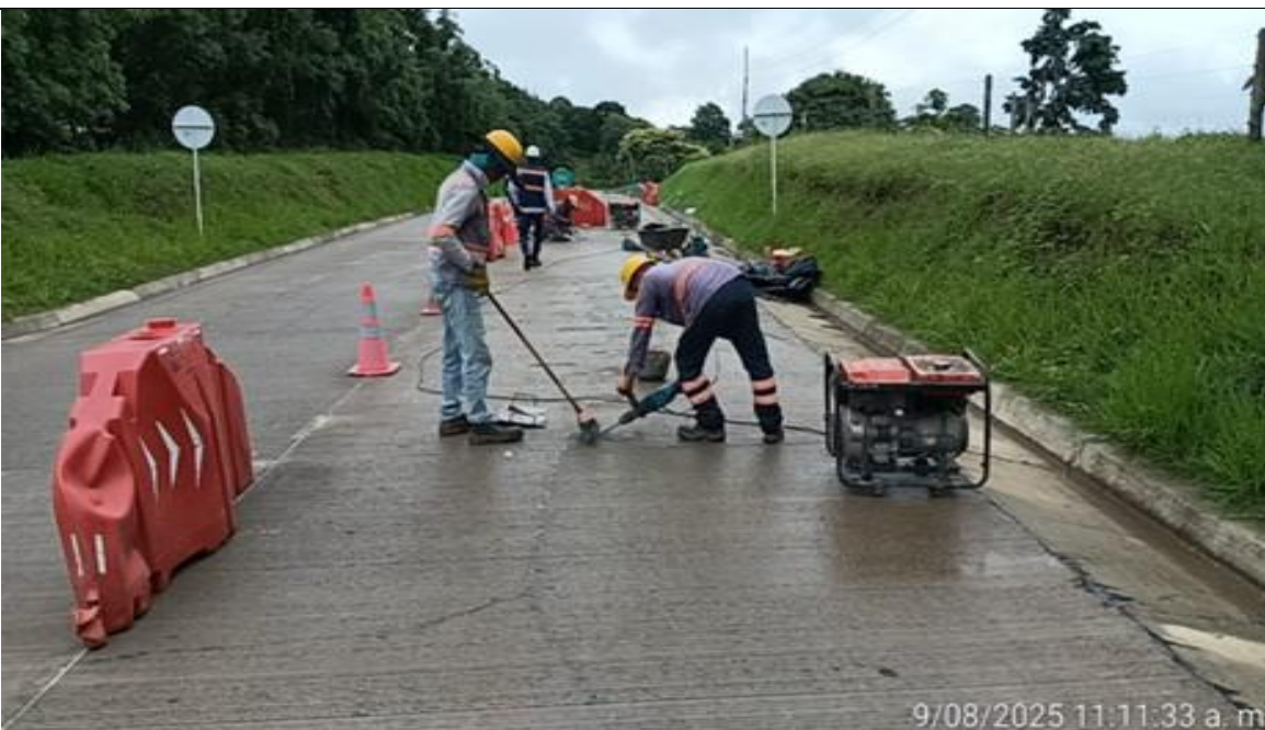
PR 11+100 a mayor lado izquierdo. Costura de losas pavimento MR-40.
