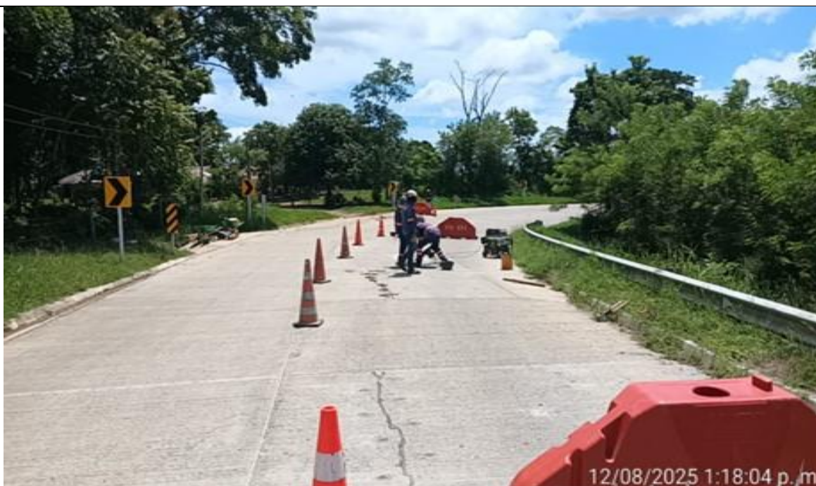
PR 11+180 a menor en el carril derecho. Costura en losas pavimento MR-40.
