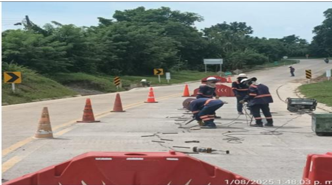
PR 8+950 carril derecho. Costuras de losas en concreto MR40.
