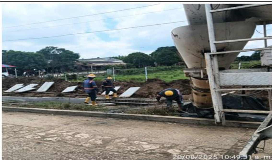
PR 35+340, lado izquierdo. Fundida de muro de canal en descole de alcantarilla.
