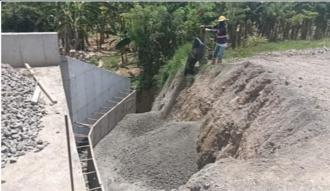
PR 34+658, lado derecho. Llenos en muro sur del box.
