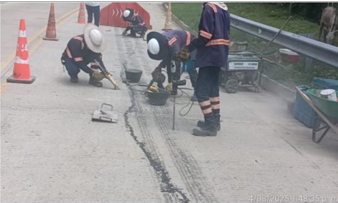
PR 9+050 a mayor carril izquierdo. Costuras de losas en concreto MR40
