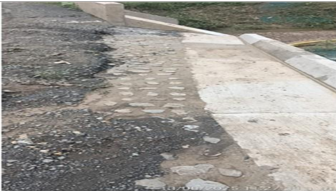
PR 42+400 lado izquierdo. Piedra pegada en sector con cunetas erosionadas por escorrentías de aguas lluvias.
