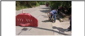
Costura de losas en el PR 15+400 y 27+300 carril derecho.
