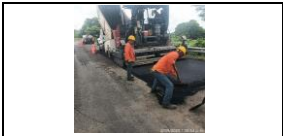
Instalación MDC19 del PR 3+580 a mayores
