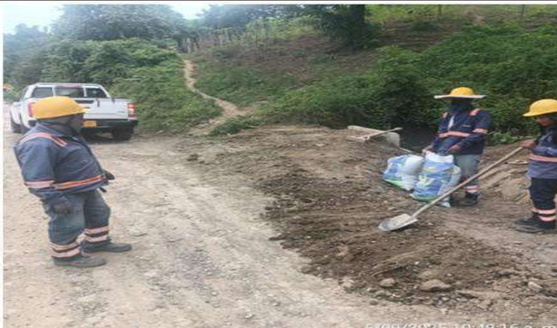
PR 41+950 de ambos lados. Control de erosión.
