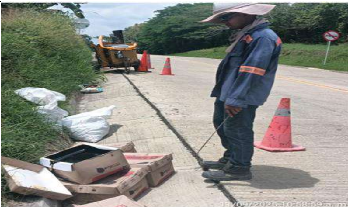
PR 9+870 lado derecho. Sello de junta de cunetas con polibit.
