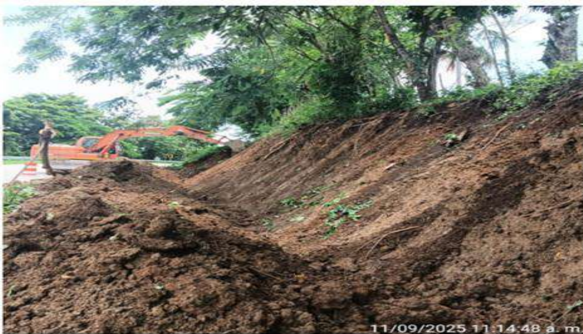
PR 9+150 lado derecho. Perfilado de talud que presenta deslizamiento.
