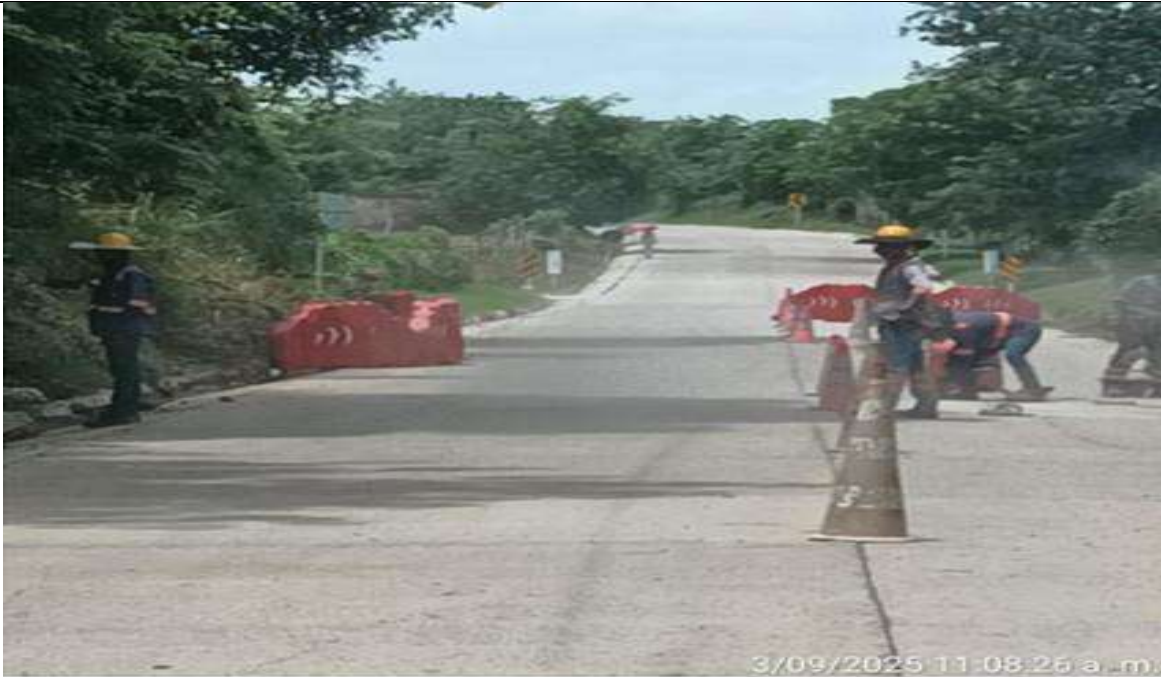
PR 13+400 carril izquierdo. Costuras de módulos en concreto MR40.
