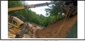
perforaciones en el talud del PR 13+950 a mayores, lado derecho.
