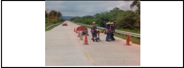
costura de losas en el PR 22+250 carril derecho.
