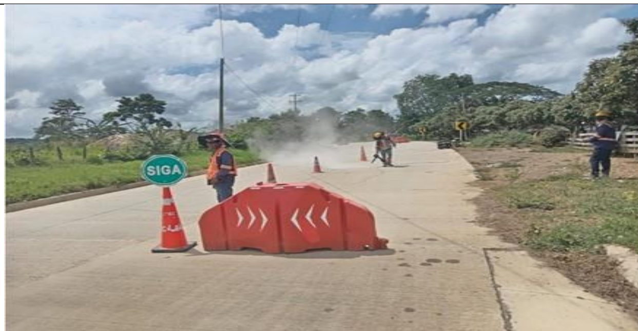
PR 29+180 lado derecho. Costura de losas.
