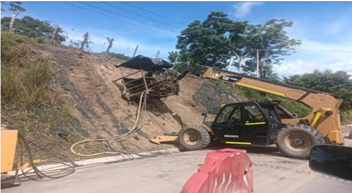
PR 4+600 margen izquierda. Perforaciones en talud.
