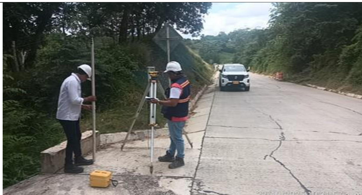
PR 12+460. Toma de desniveles sobre losas afectadas en obras de drenaje.
