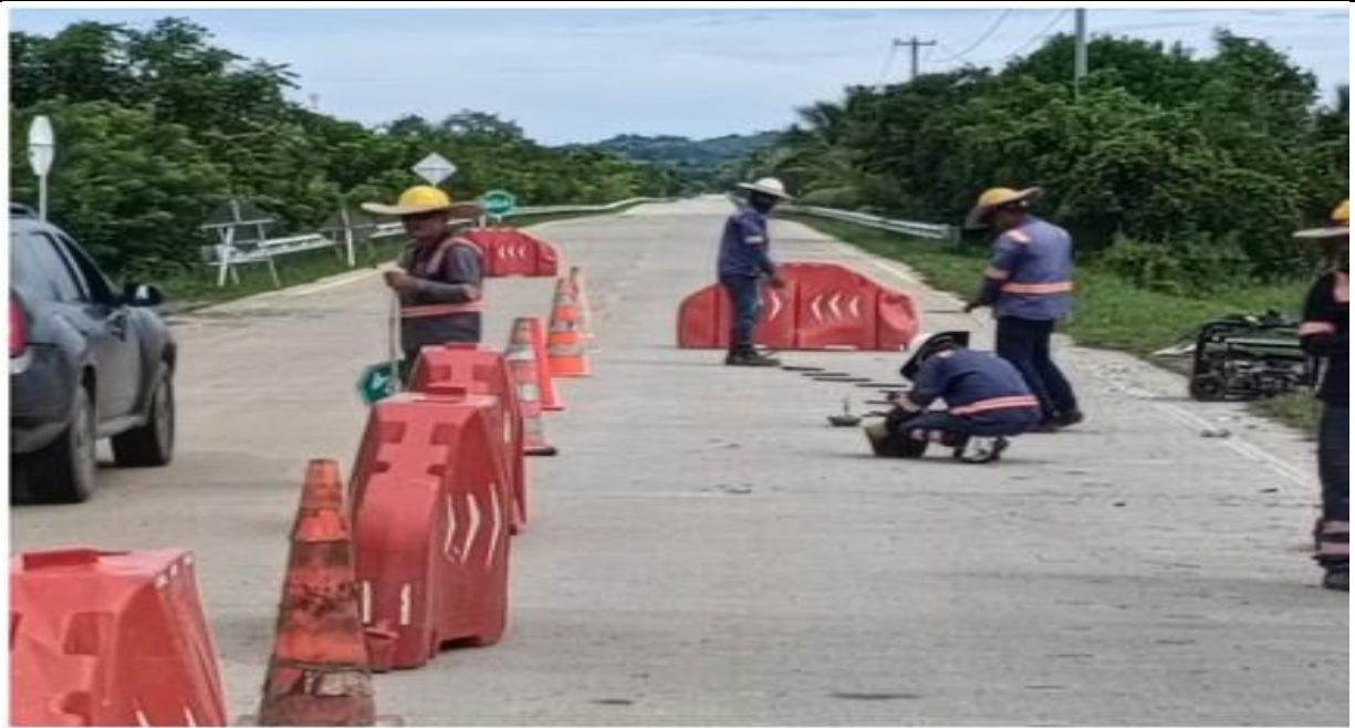
PR 20+330 carril derecho. Costuras de losas en concreto MR40.
