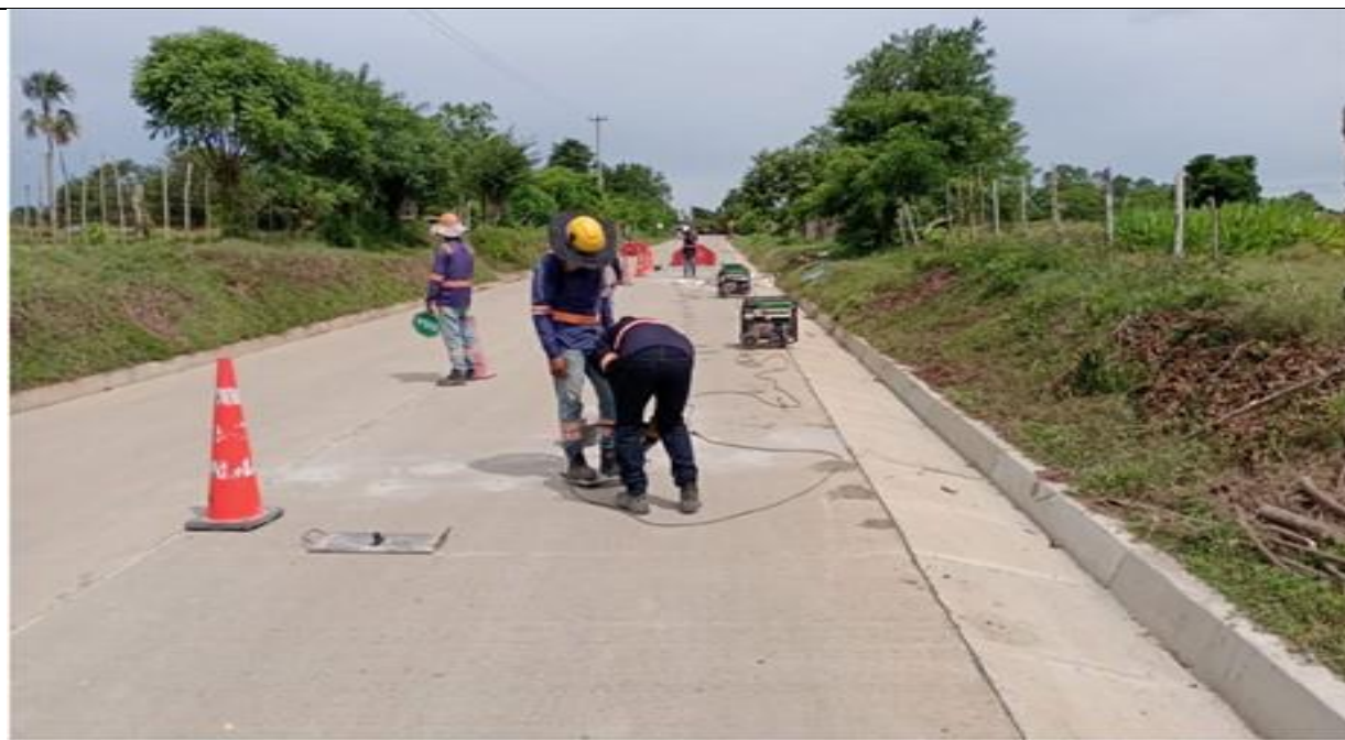
PR 28+830 carril derecho. Costura y sello de losas con grietas.
