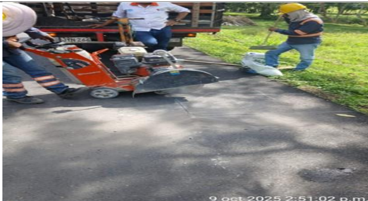
PR 0+760 carril izquierdo. Extracción de panela en sobre carpeta MDC19.
