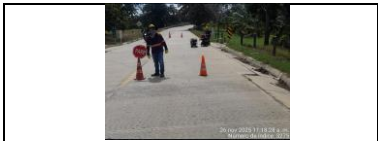
Costuras de losas PR10+100 al PR10+150 carril izquierdo.
