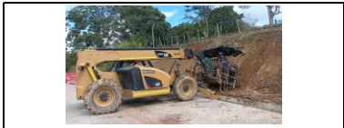
perforaciones en el talud del PR 10+750, margen derecha.
