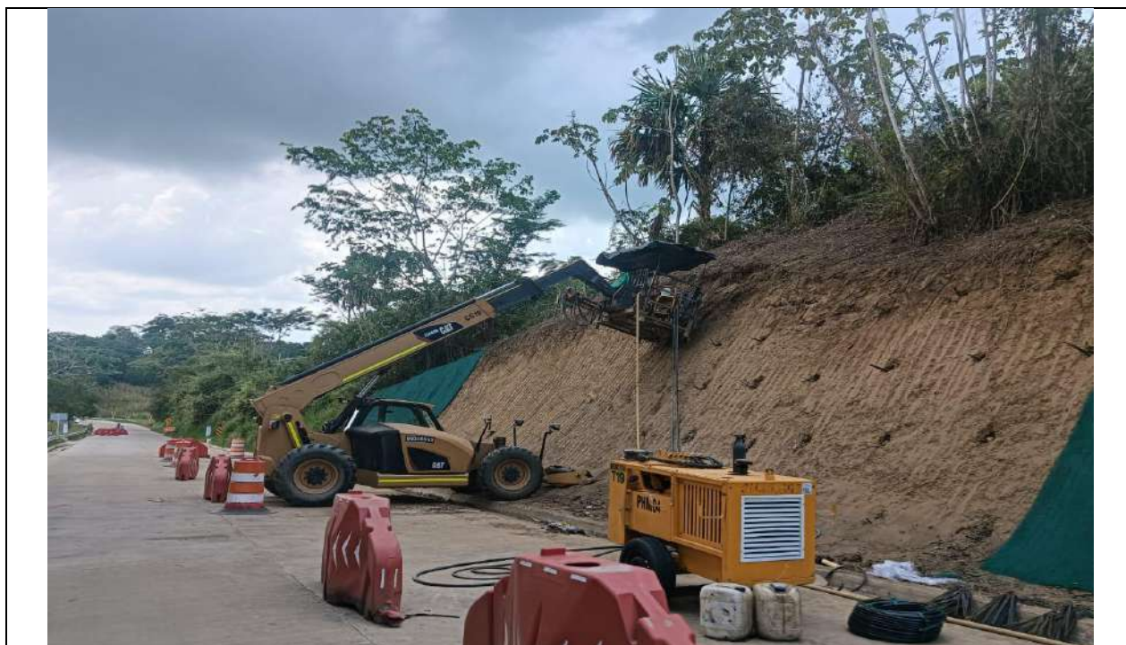
Perforaciones en el PR 12+530 a mayores, lado izquierdo.
