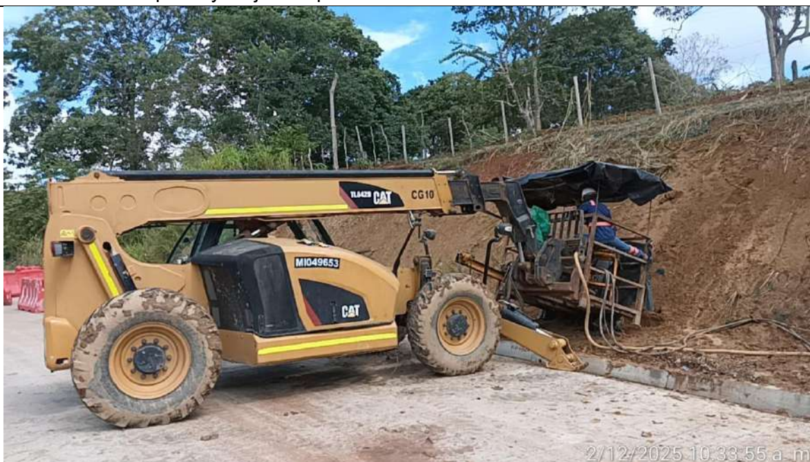
Perforaciones en el talud del PR 10+750, margen derecha.
