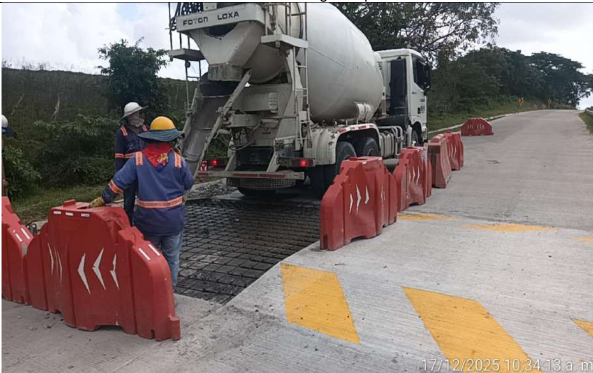
Fundida de resaltó tipo Pompeyano en el PR 27+577 carril derecho.
