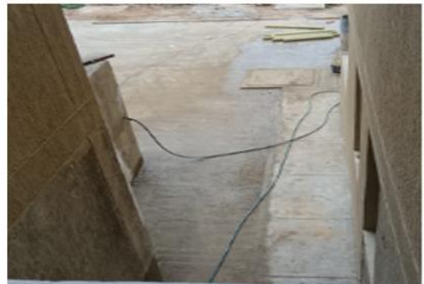
EXTERIOR ZONA DE GABINETE DE CONTADORES DE ENERGIA ENTRADA POSTERIOR
