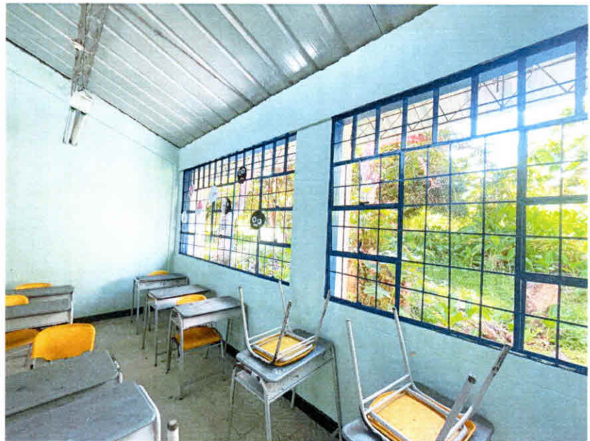
Estado final de ventanas y muros internos aula de clase.
