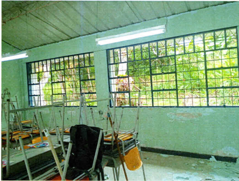
Estado inicial de ventanas y muros salón de clase.
