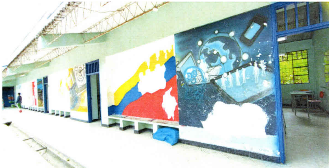
Estado inicial fachada salón 604 – sala de profesores
