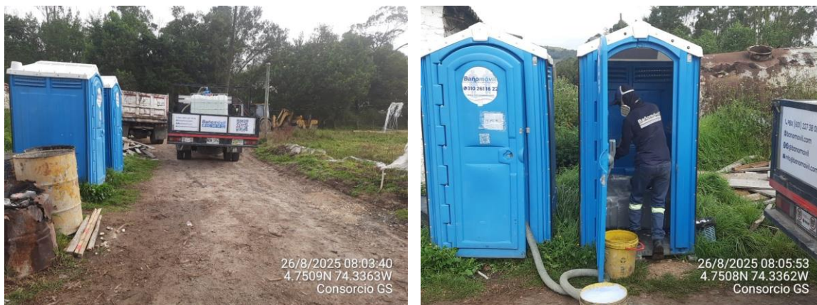
Mantenimiento baterías sanitarias ubicadas en el campamento
