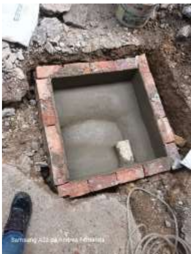
CAJAS DE INSPECCION
