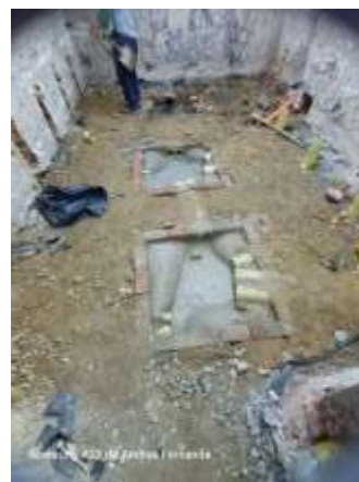
CAJAS DE INSPECCION
