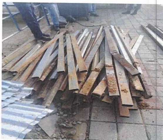
Fotografia 1. Daños en cerramiento provisional de obra.
