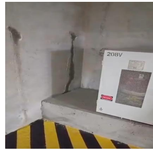
FILTRACIONES PISCINA RECREATIVA EN ZONA SUBTERRANEA
