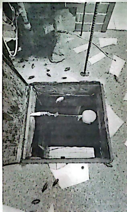
Tanque Subterraneo Infestado de Insectos, tapa en mal estado, sin mantenimiento y con motobomba dañada.
