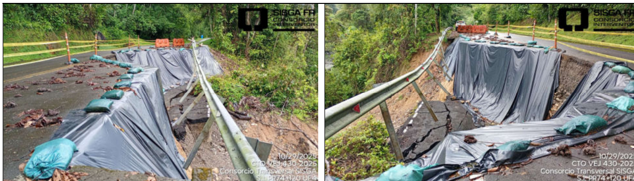
Sitio PR74+080 al PR74+120 Ruta 5608. Unidad Funcional 4. Perdida parcial de la banca por creciente súbita del río Lengupá.
