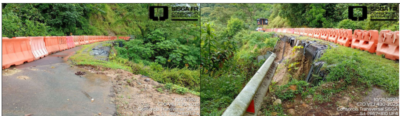
Sitio PR67+810 Ruta 5608. Unidad Funcional 4. Se presenta erosión en talud inferior, debido a crecienta súbita del río Lengupá. No relacionado en el Apéndice Técnico 1.
