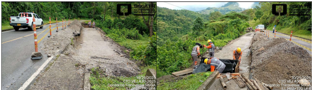
Sitio PR51+770 Ruta 5608. Unidad Funcional 4. Hundimiento de la calzada.
