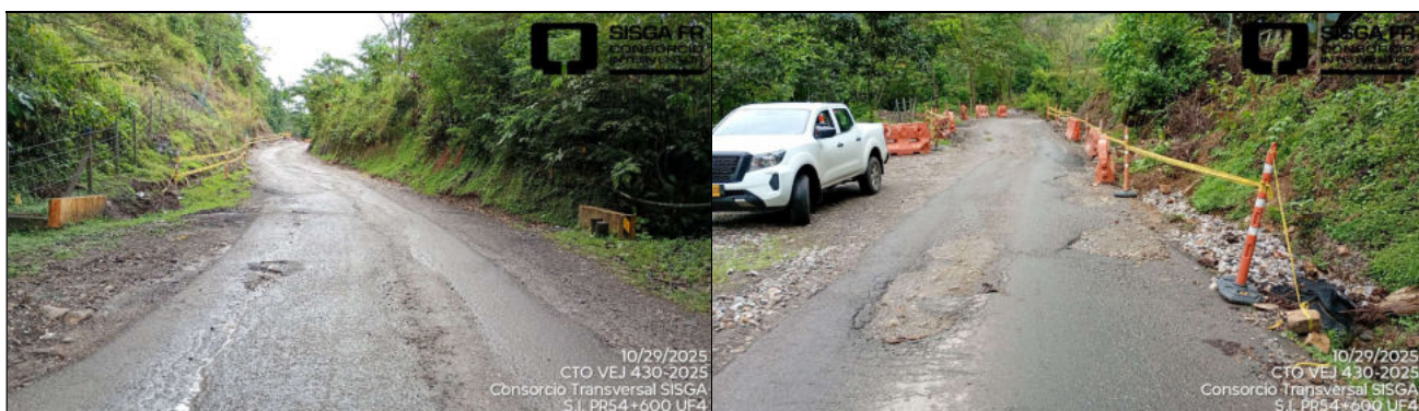
Sitio PR54+600 Ruta 5608. Unidad Funcional 4. Movimiento en masa. No relacionado en el Apéndice Técnico 1.
