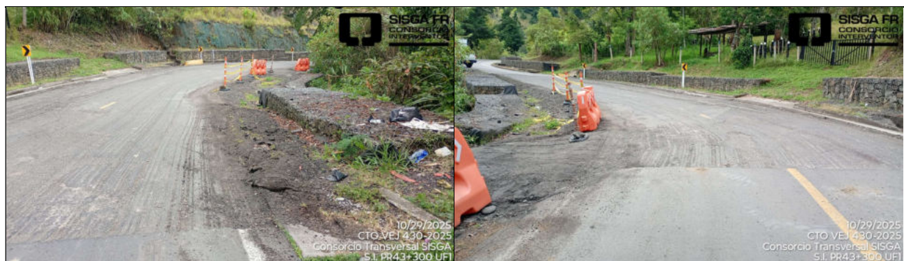
Sitio PR43+300. Ruta 5607. Unidad Funcional 1. Pérdida de la banca por Hundimiento, No relacionado en el Apéndice Técnico 1 Actividades de Mantenimiento: Demolición de carpeta de rodadura afectada fresado.
