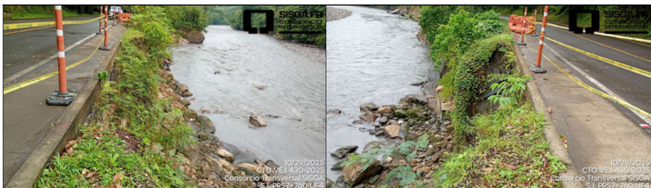
Sitio PR57+680 al PR57+760 Ruta 5608. Unidad Funcional 4. Se presenta erosión en talud inferior y perdida de soporte de la cuneta, debido a creciente súbita del río Lengupá. No relacionado en el Apéndice Técnico 1.
