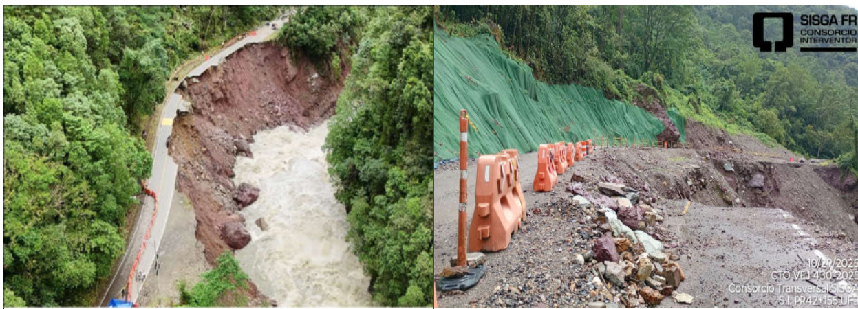
PR42+020. Sitio Inestable. Ruta 5608. Unidad Funcional 3.
