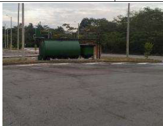
Planta de tratamiento de agua residual (PTAR)
