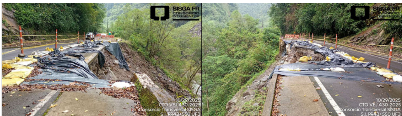
Sitio PR42+550 al PR42+590 Ruta 5608. Unidad Funcional 3. Se presenta perdida parcial de banca y erosión en talud inferior debido a creciete súbita del río Batá. No relacionado en el Apéndice Técnico 1.
