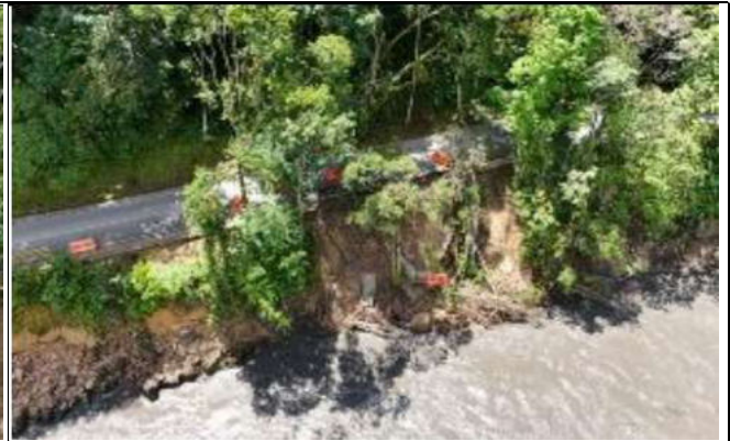
Activación de procesos de inestabilidad PR57+910 UF4
