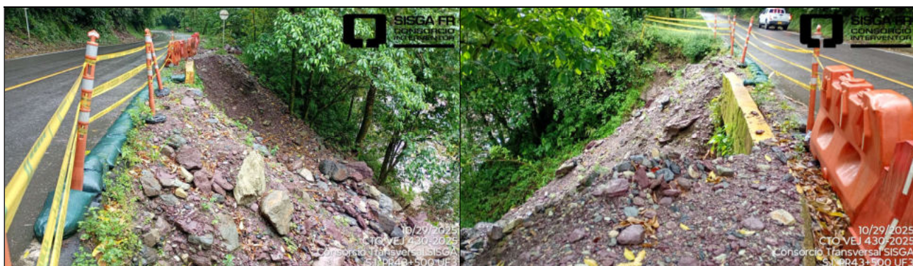
Sitio PR43+500 Ruta 5608. Unidad Funcional 3. Desconfinamiento de la vía por avenida torrencial. No relacionado en el Apéndice Técnico 1.
