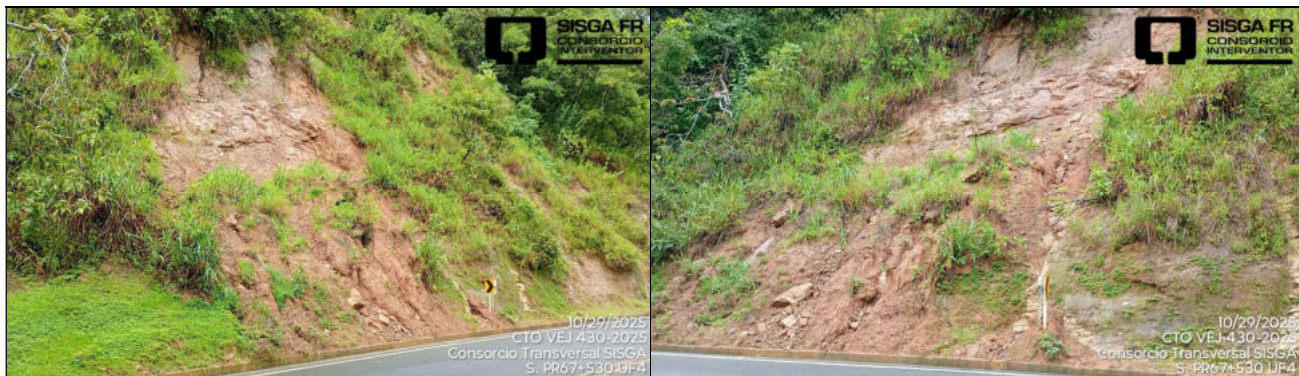
Sitio PR67+530 Ruta 5608. Unidad Funcional 4. Inestabilidad generada por la saturación que tiene el terreno, movimiento en masa. No relacionado en el Apéndice Técnico 1.
