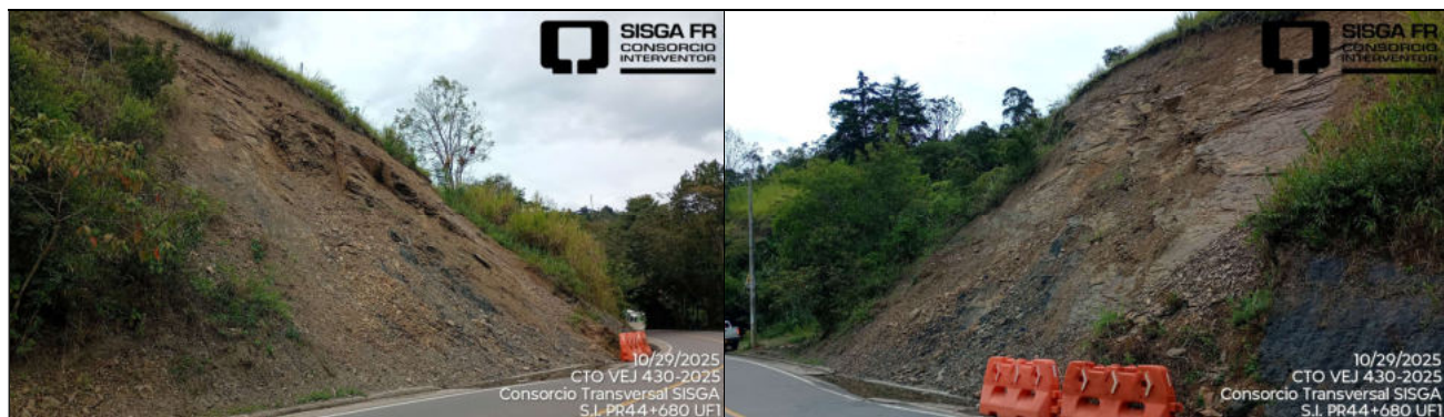
Sitio PR44+680 Ruta 5607. Unidad Funcional 1. Procesos de inestabilidad asociados al flujo de material y caída de rocas por el alto grado de erosión. No relacionado en el Apéndice Técnico 1.
