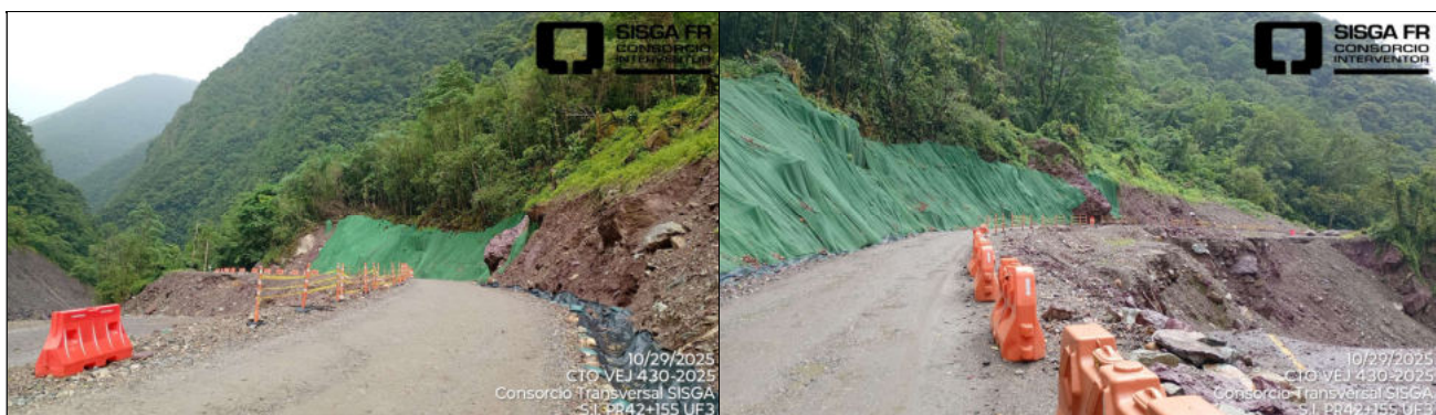
Sitio PR41+965 al PR42+155 Ruta 5608. Unidad Funcional 3. Se presenta pérdida total de la banca debido a creciente súbita del río Batá. No relacionado en el Apéndice Técnico 1. Actividades de Mantenimiento Construcción de carreteable.
