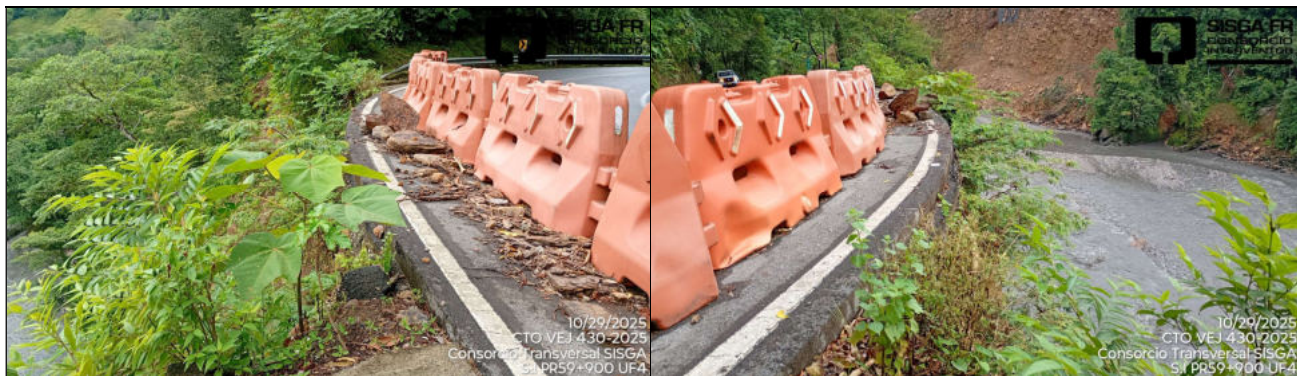
Sitio PR59+900 Ruta 5608. Unidad Funcional 4. Se presenta erosión en talud inferior y pérdida de soporte de la cuneta, debido a creciente súbita del río Lengupá. No relacionado en el Apéndice Técnico 1.
