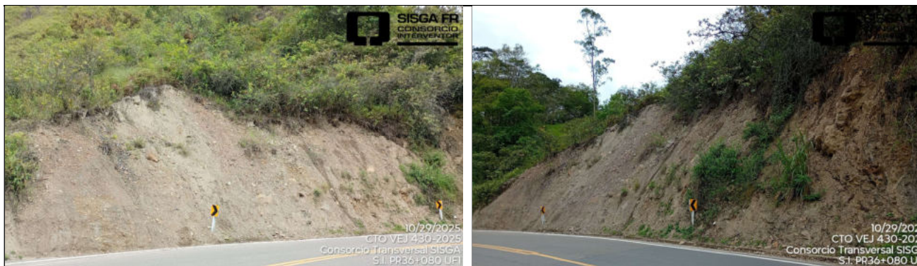
Sitio PR36+080 Ruta 5607 Unidad Funcional 1. Inestabilidad generada por la saturación que tiene el terreno. Activación de movimiento en masa. No relacionado en el Apéndice Técnico 1.
