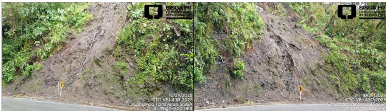
Sitio PR49+200 Ruta 5608. Unidad Funcional 4. Inestabilidad generada por la saturación que tiene el terreno, movimiento en masa. No relacionado en el Apéndice Técnico 1.
