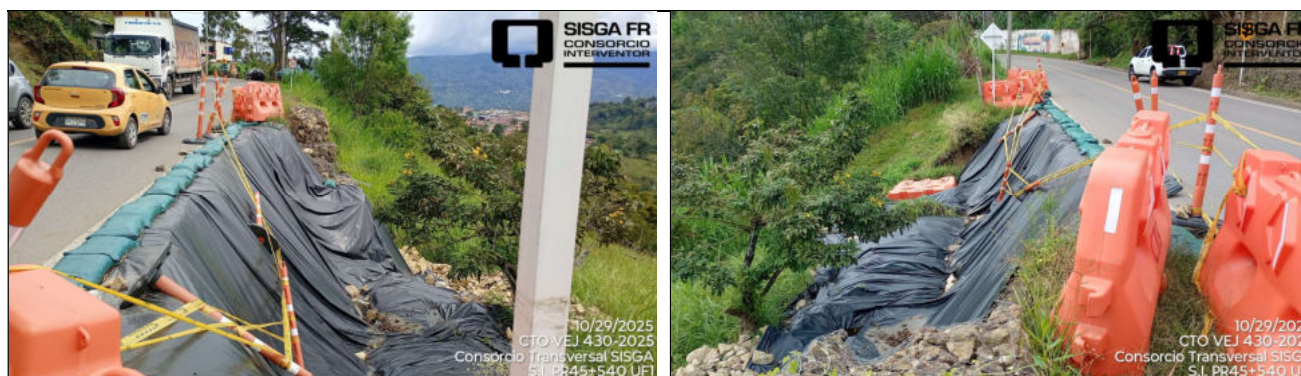
Sitio PR45+540 Ruta 5607. Unidad Funcional 1. Proceso de Inestabilidad geotécnica. No relacionado en Apéndice Técnico 1.
