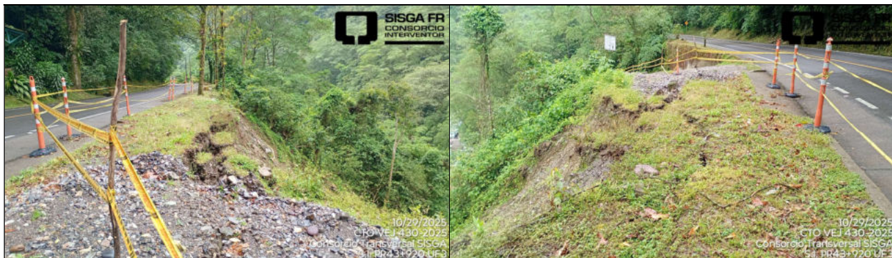
Sitio PR42+800 Ruta 5608. Unidad Funcional 3. Se presenta desconfinamiento de la vía, debido a creciete súbita del río Batá. No relacionado en el Apéndice Técnico 1.
