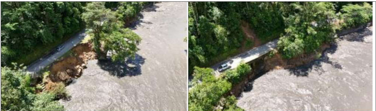
Activación de procesos de inestabilidad PR57+700 UF4
