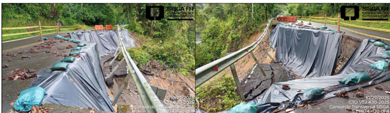
Sitio PR74+080 al PR74+120 Ruta 5608. Unidad Funcional 4. Se presenta erosión en talud inferior, debido a creciente súbita del río Lengupá. No relacionado en el Apéndice Técnico 1.
