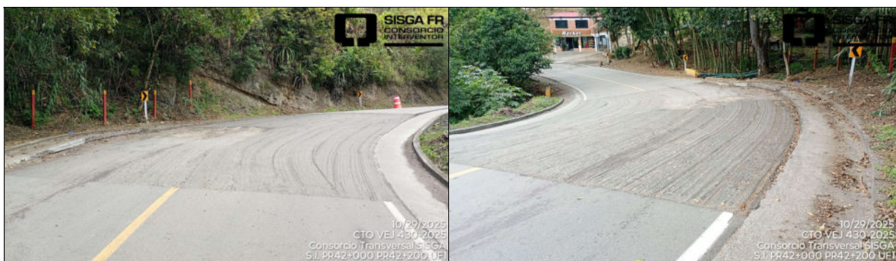
Sitio PR42+000 al PR42+200. Ruta 5607. Unidad Funcional 1. Movimiento de reptación del depósito de coluvión sobre el cual se encuentra cimentada la vía. No relacionado Apéndice Técnico 1.
