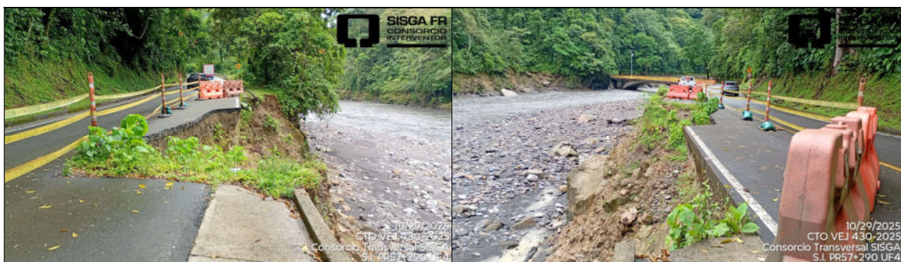
Sitio PR57+240 a PR57+290 Ruta 5608. Unidad Funcional 4 se presenta pérdida de soporte en la cuneta con pérdida parcial de la banca, afectaciones en geocontenedores, debido a creciente súbita del río Lengupá. No relacionado en el Apéndice Técnico 1.
