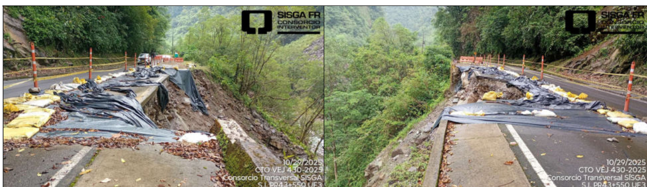
Sitio PR42+550 al PR42+590 Ruta 5608. Unidad Funcional 3. Se presenta pérdida parcial de banca y erosión en talud inferior debido a creciente súbita del río Batá. No relacionado en el Apéndice Técnico 1.
