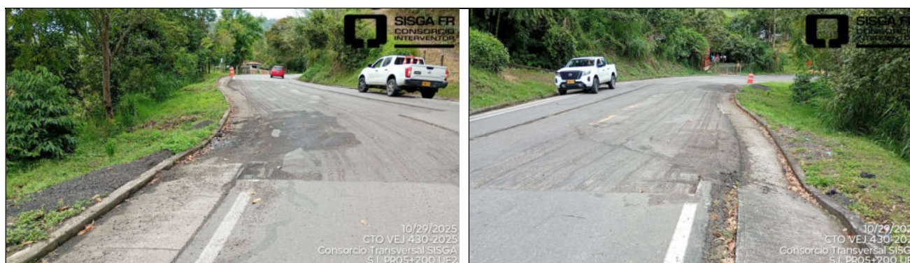
Sitio Contractual PR5+200 Ruta 5608. Unidad Funcional 2. Hundimiento de la calzada movimiento rotacional. No relacionado en Apéndice Técnico 1.
