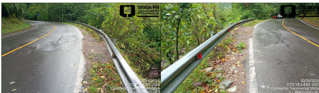
Sitio PR43+920 Ruta 5608. Unidad Funcional 3. Perdida de lleno en el trasdós del muro, debido a creciete súbita del río Batá. No relacionado en el Apéndice Técnico 1.
