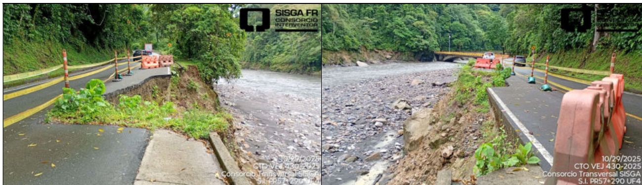
Sitio PR57+240 a PR57+290 Ruta 5608. Unidad Funcional 4. se presenta perdida de soporte en la cuneta pérdida parcial de la banca, afectaciones en geocontenedores, debido a creciente súbita del río Lengupá. No relacionado en el Apéndice Técnico 1.
