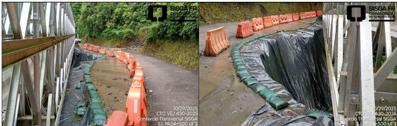
Sitio PR34+500 Ruta 5608. Unidad Funcional 3. Se presenta pérdida total de la banca debido a avenida torrencial. No relacionado en el Apéndice Técnico 1.
