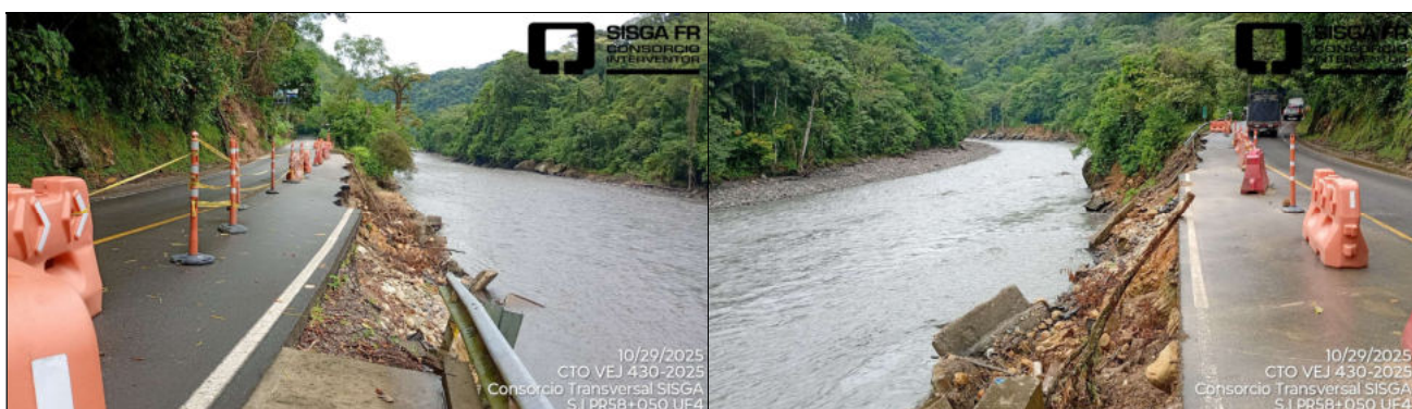
Sitio PR58+020 al PR58+090 Ruta 5608. Unidad Funcional 4. Se presenta erosión en talud inferior y pérdida de soporte de la cuneta, debido a creciente súbita del río Lengupá. No relacionado en el Apéndice Técnico 1.
