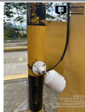
Equipos de Video – Estación de Peaje San Luis de Gaceno, CIS FR
