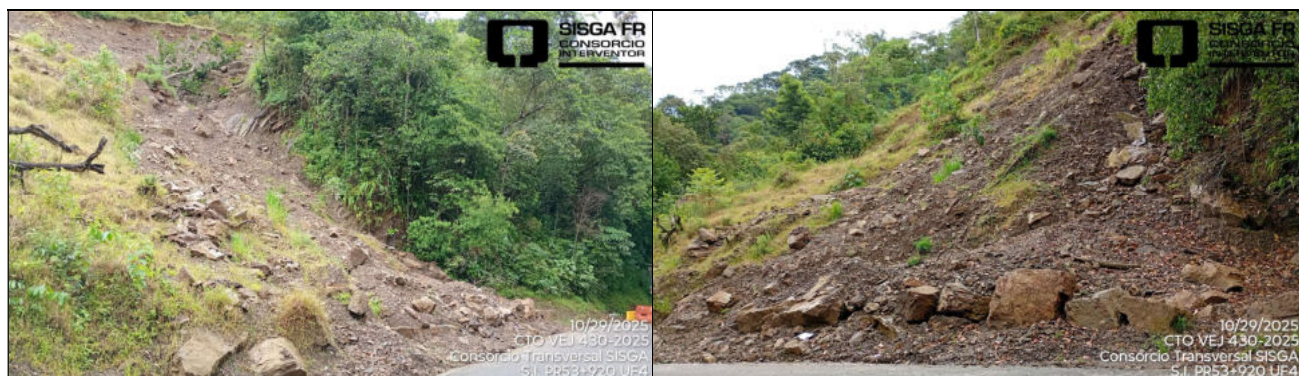
Sitio PR53+920 Ruta 5608. Unidad Funcional 4. Inestabilidad generada por la saturación que tiene el terreno, movimiento en masa. No relacionado en el Apéndice Técnico 1.
