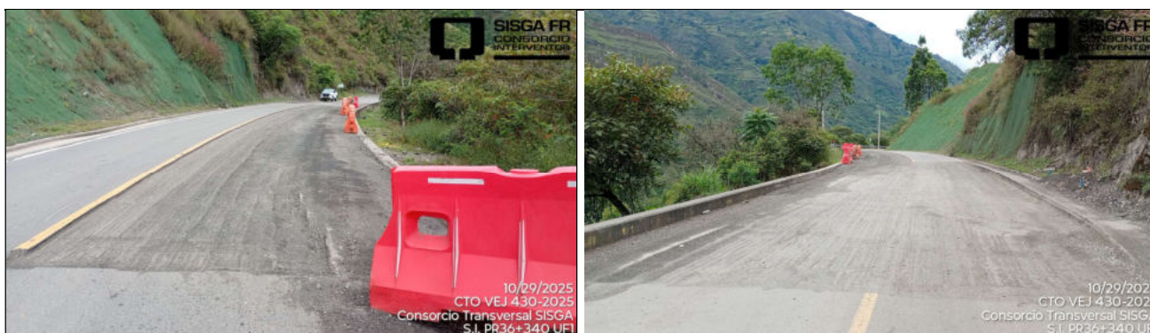
Sitio Contractual PR36+340. Ruta 5607. Unidad Funcional 1. Este sector se ha visto afectado por el movimiento en masa tipo rotacional, que ha afectado el talud interno de la vía. El movimiento en talud externo ocasionó la pérdida de confinamiento del material, lo que generó la pérdida parcial de la banca que conforma el margen externo de la vía en este sector.
