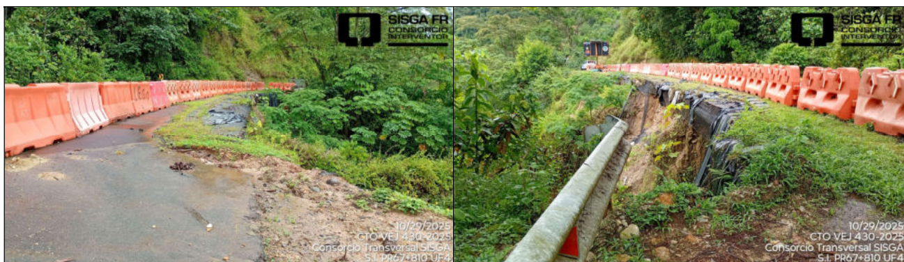
Sitio PR67+810 Ruta 5608. Unidad Funcional 4. Se presenta erosión en talud inferior, debido a creciente súbita del río Lengupá. No relacionado en el Apéndice Técnico 1.
