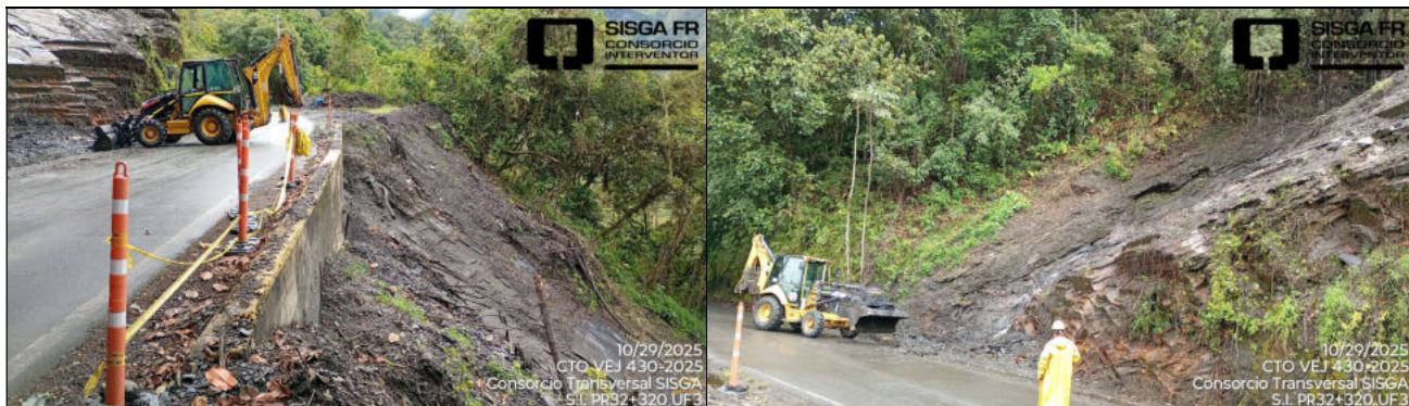
Sitio PR32+320 Ruta 5608. Unidad Funcional 3. Proceso de remoción en masa tipo deslizamiento traslacional de detritos y avenida torrencial. No relacionado en el Apéndice Técnico 1.
