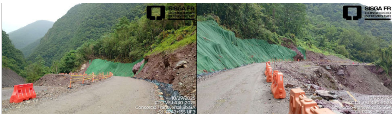
Sitio PR41+965 al PR42+155 Ruta 5608. Unidad Funcional 3. Se presenta pérdida total de la banca debido a creciete súbita del río Batá. No relacionado en el Apéndice Técnico 1.
