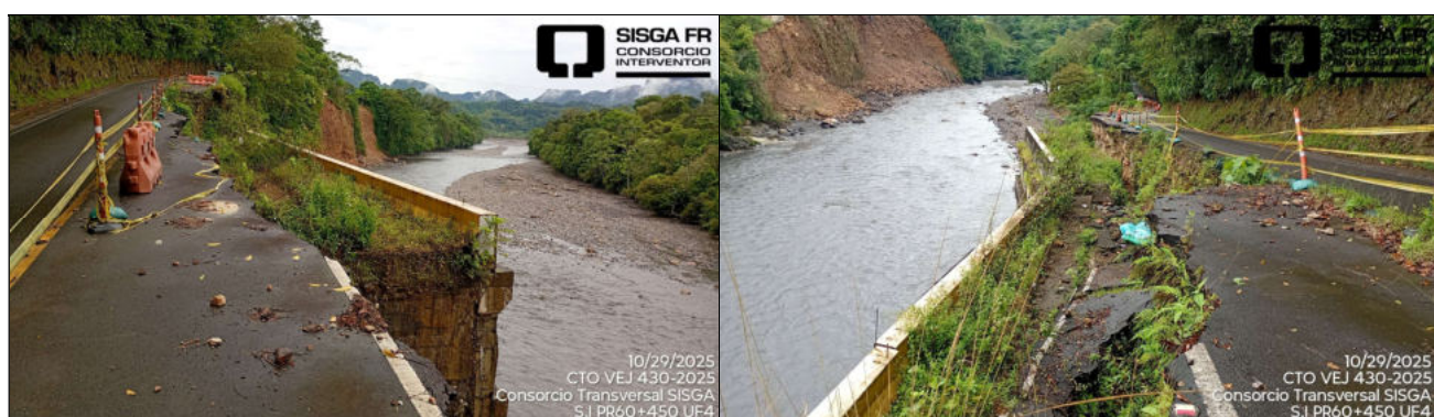
Sitio PR60+450 Ruta 5608. Unidad Funcional 4. Pérdida de la Banca, debido a creciente súbita del Río Lengupá. No relacionado en el Apéndice Técnico 1.
