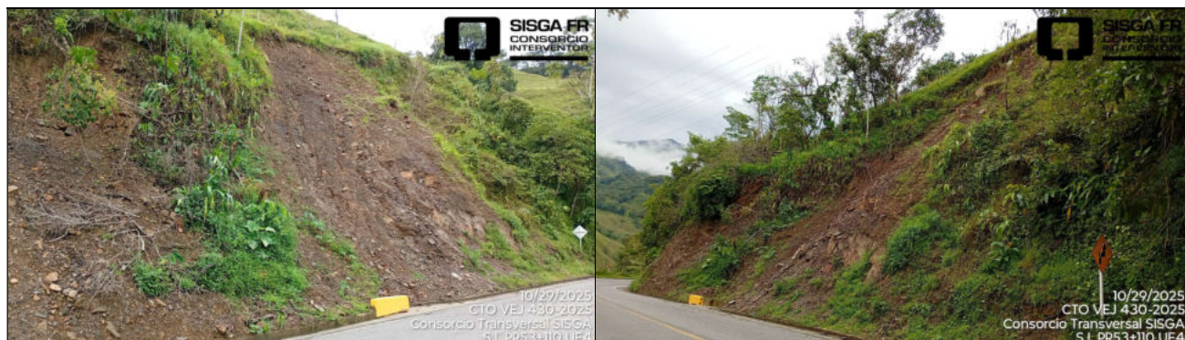
Sitio PR53+110 Ruta 5608. Unidad Funcional 4. Inestabilidad generada por la saturación que tiene el terreno, movimiento en masa. No relacionado en el Apéndice Técnico 1.
