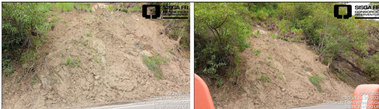
Sitio PR39+900. Ruta 5607. Unidad Funcional 1. Inestabilidad generada por la saturación que tiene el terreno. Activación de movimiento en masa – Talud superior
