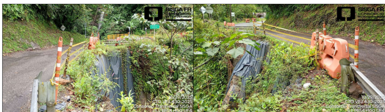
Sitio PR54+100 Ruta 5608. Unidad Funcional 4. Perdida de la banca. No relacionado en el Apéndice Técnico 1.
