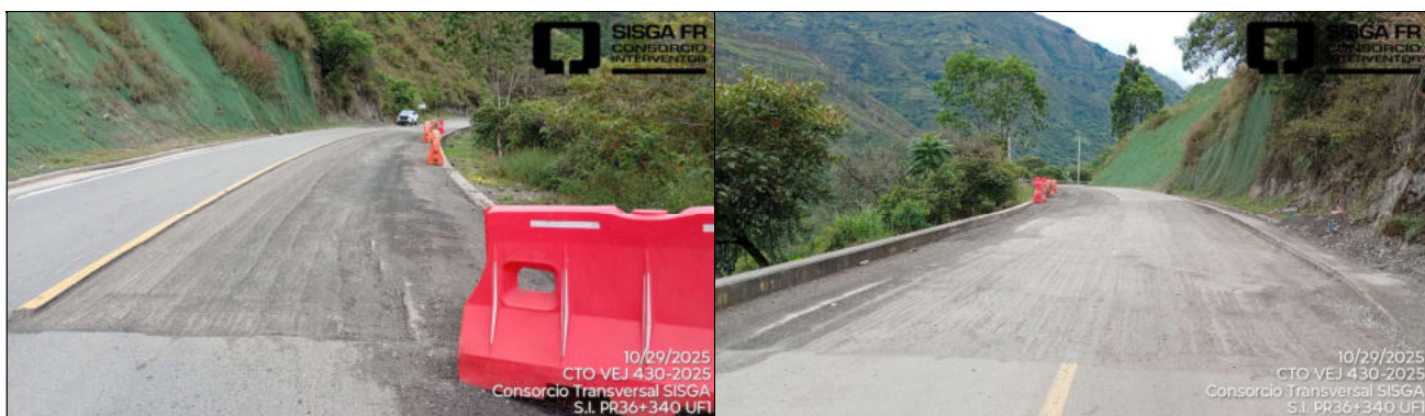
Sitio PR36+340. Ruta 5607. Unidad Funcional 1. Hundimiento de la calzada. Actividades de Mantenimiento: Fresado de la carpeta asfáltica.
