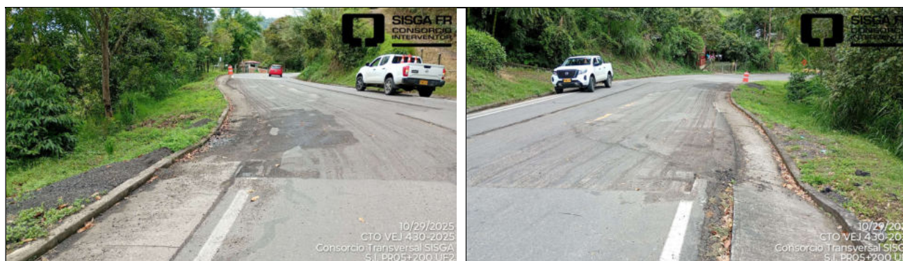
Sitio PR5+200 Ruta 5608. Unidad Funcional 2. Hundimiento de la calzada movimiento rotacional. No relacionado en Apéndice Técnico 1. Actividades de Mantenimiento: Demolición de carpeta de rodadura afectada fresado.
