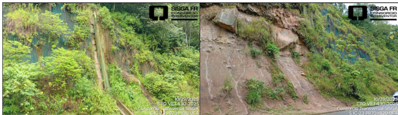
Sitio Contractual IC-23 – PR70+820. Ruta 5608. Unidad Funcional 4. En la ilustración anterior se aprecian la cantidad de bloques que han caído, se observan zonas sin manto para control de erosión, zonas con el manto, la malla triple torsión y pernos sueltos.
