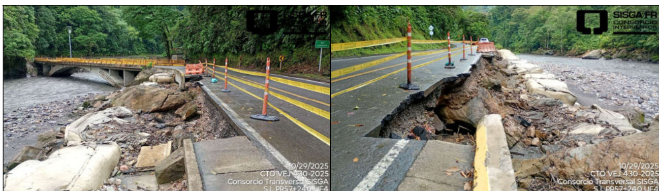
Sitio PR57+180 a PR57+240 Ruta 5608. Unidad Funcional 4. se presenta pérdida de soporte en la cuneta pérdida parcial de la banca, afectaciones en geocontenedores, debido a creciente súbita del río Lengupá. No relacionado en el Apéndice Técnico 1.
