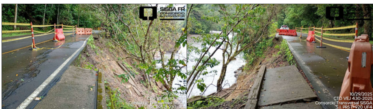
Sitio PR57+840 al PR57+920 Ruta 5608. Unidad Funcional 4. Se presenta erosión en talud inferior y perdida de soporte de la cuneta, debido a creciente súbita del río Lengupá. No relacionado en el Apéndice Técnico 1.
