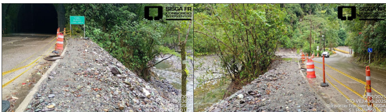
Sitio PR41+540 a PR41+580 Ruta 5608. Unidad Funcional 3. Erosión en talud inferior debido a creciente súbita del río Batá. No relacionado en el Apéndice Técnico 1.
