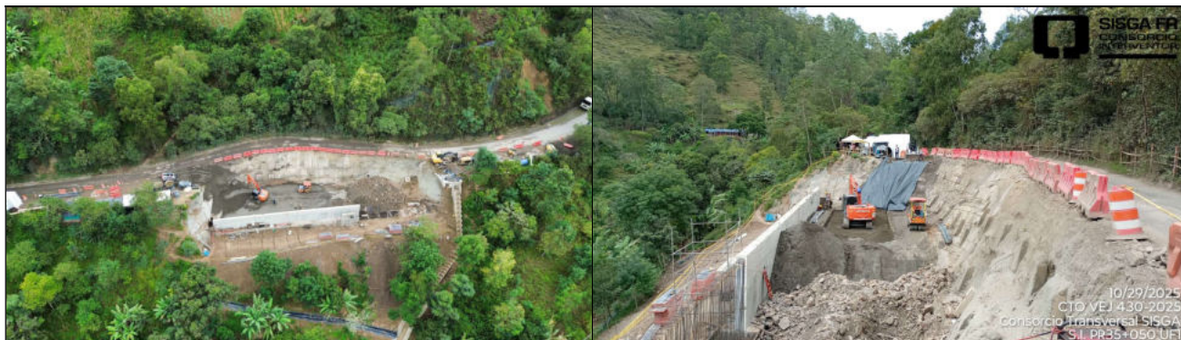
Sitio PR35+050. Ruta 5607. Unidad Funcional 1. Perdida de la banca. Paso controlado a un carril, control vial 24 horas. En ejecución las obras para la recuperación de la banca y solución del Sitio Inestable.
