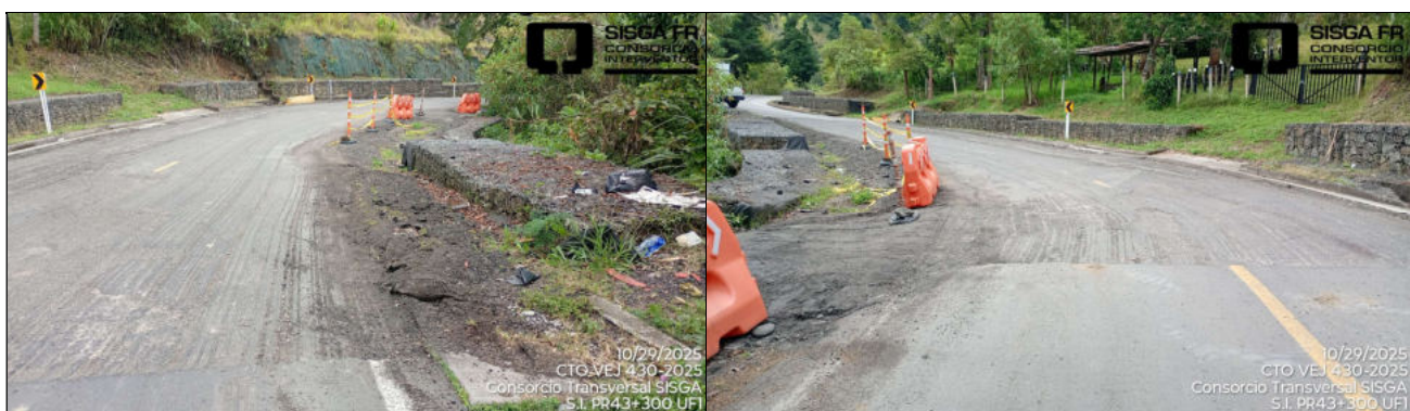
Sitio PR43+300. Ruta 5607. Unidad Funcional 1. Perdida de la banca por Hundimiento, No relacionado en el Apéndice Técnico 1
