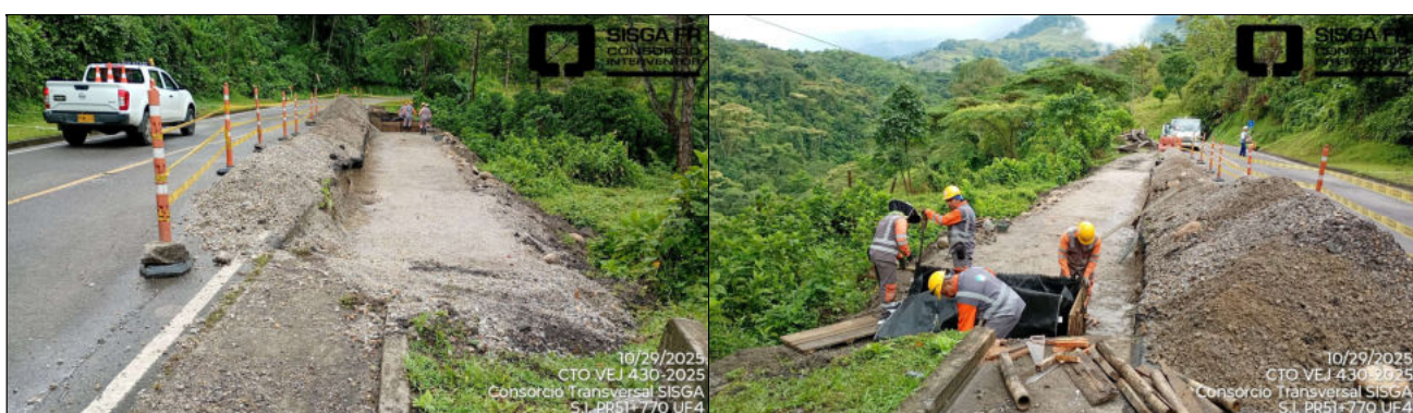
Sitio Contractual PR51+770 Ruta 5608. Unidad Funcional 4. Hundimiento de la calzada.
