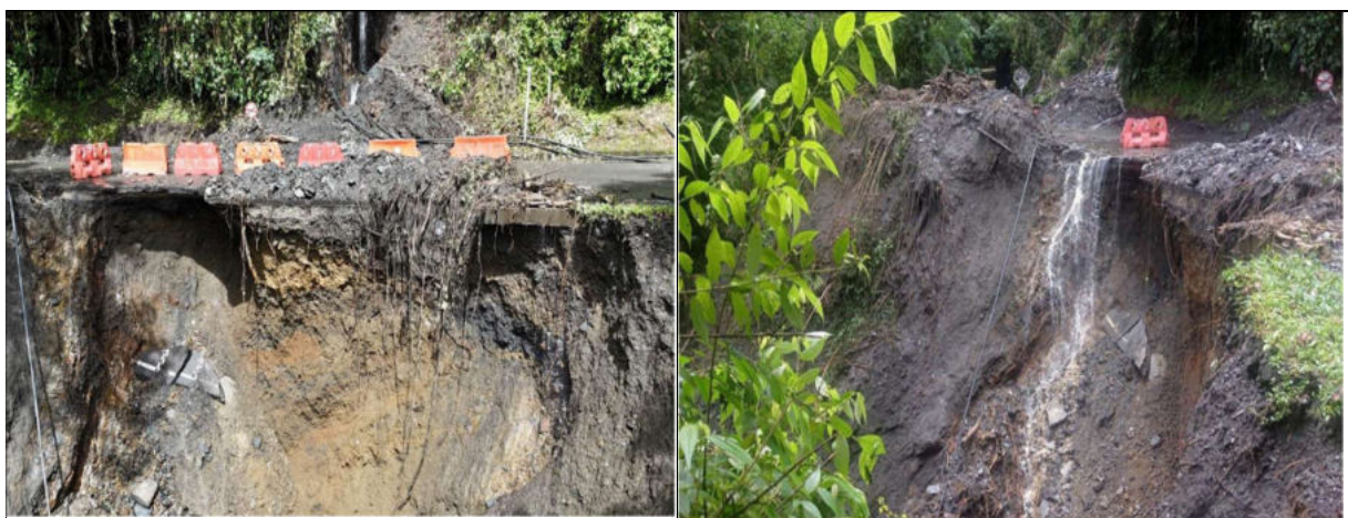
Pérdida Parcial de banca PR34+520 – UF3, Avenida Torrencial.
