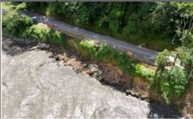
Activación de procesos de inestabilidad PR57+800 UF4
