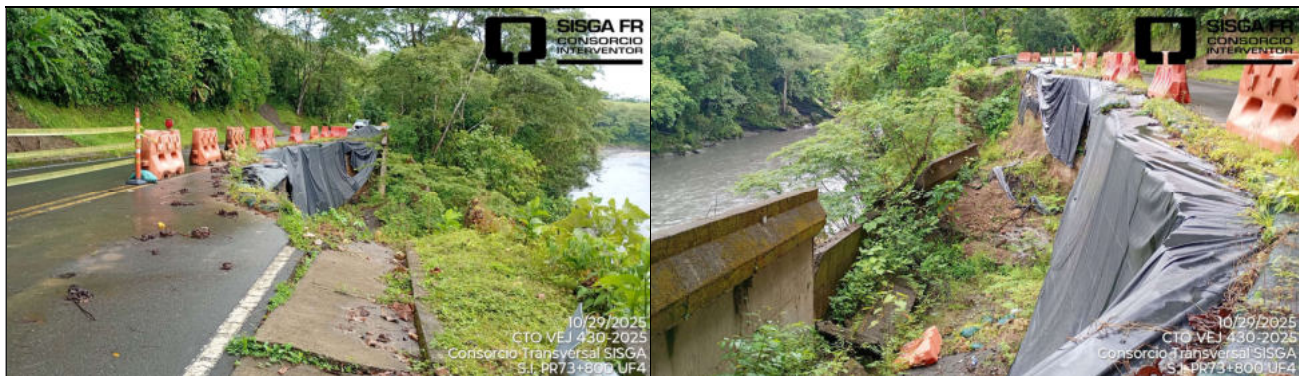
Sitio PR73+800 Ruta 5608. Unidad Funcional 4. Perdida de la banca, No relacionado en el Apéndice Técnico 1.
