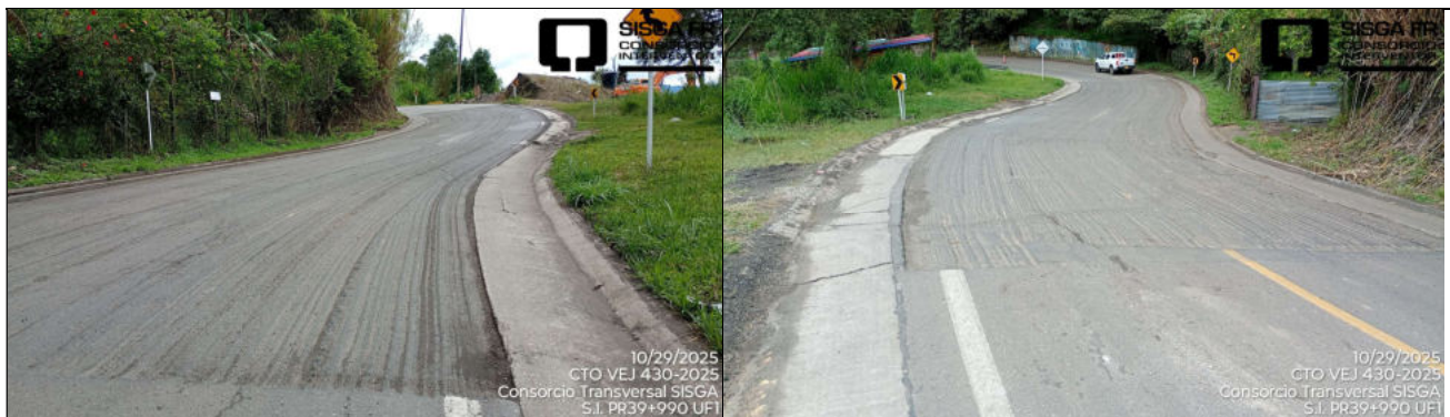
Sitio PR39+990 Ruta 5607. Unidad Funcional 1. Hundimiento de la calzada. No relacionado en Apéndice Técnico 1
