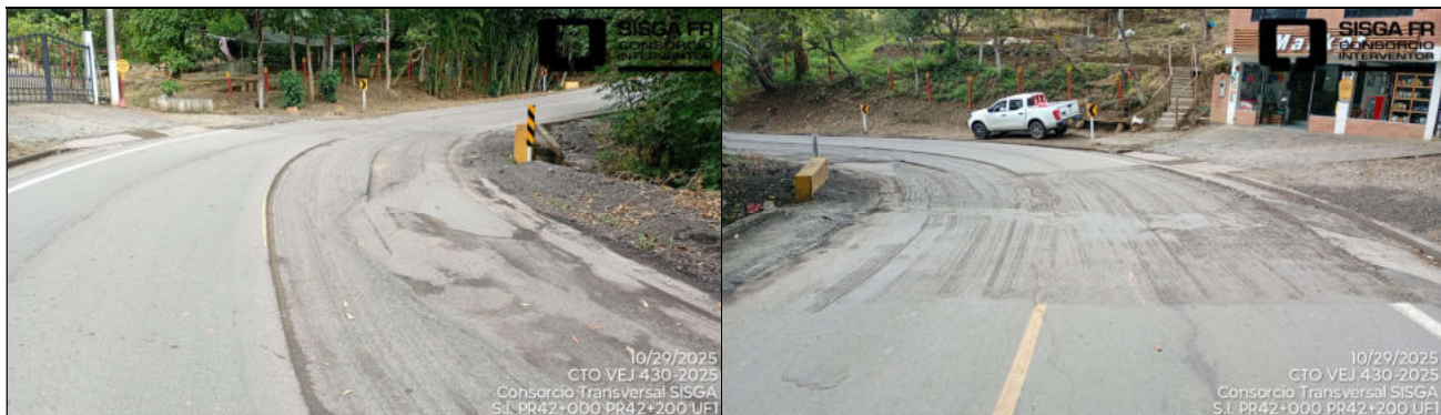
Sitio PR42+000 al PR42+200. Ruta 5607. Unidad Funcional 1. Movimiento de reptación del depósito de coluvión sobre el cual se encuentra cimentada la vía. No relacionado en el Apéndice Técnico 1.
