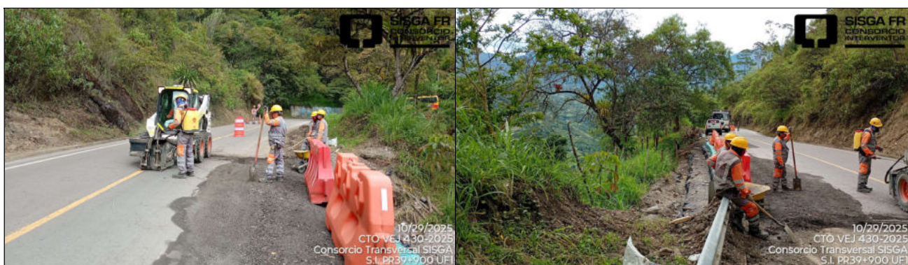
Sitio PR39+900 Ruta 5607. Unidad Funcional 1. Hundimiento de la calzada - No relacionado en el Apéndice Técnico Actividades de Mantenimiento: Se realiza la construcción de una estructura de contención con 18 geo bolsas rellenas de material de afirmado (alta resistencia), con el propósito de recuperar la banca en el carril derecho, confinar y restaurar la estructura de la vía.
