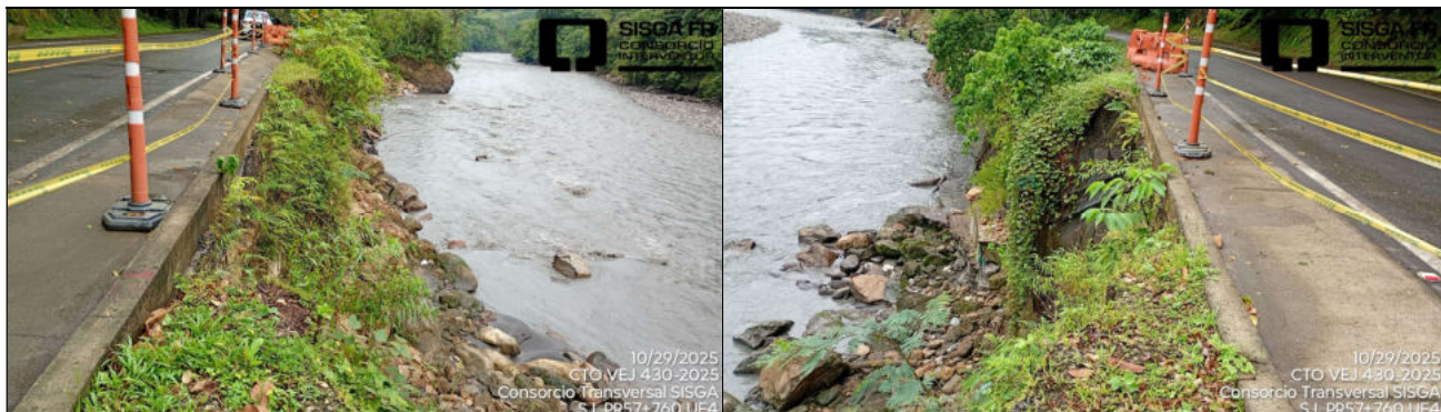
Sitio PR57+680 al PR57+760 Ruta 5608. Unidad Funcional 4. Se presenta erosión en talud inferior y pérdida de soporte de la cuneta, debido a creciente súbita del río Lengupá. No relacionado en el Apéndice Técnico 1.
