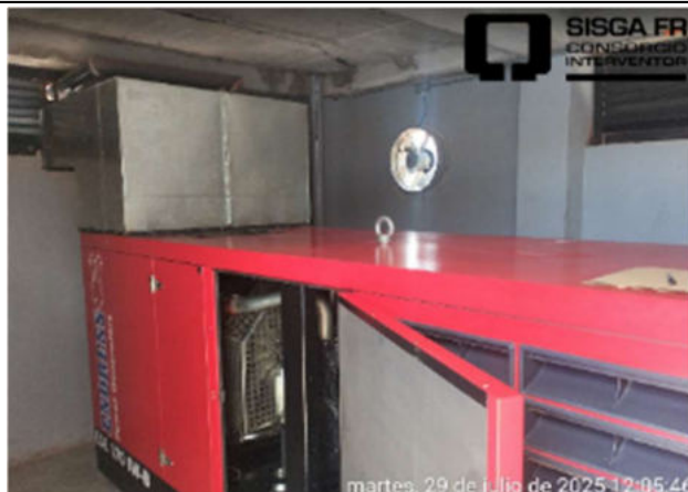
Planta Eléctrica y combustible de reserva
