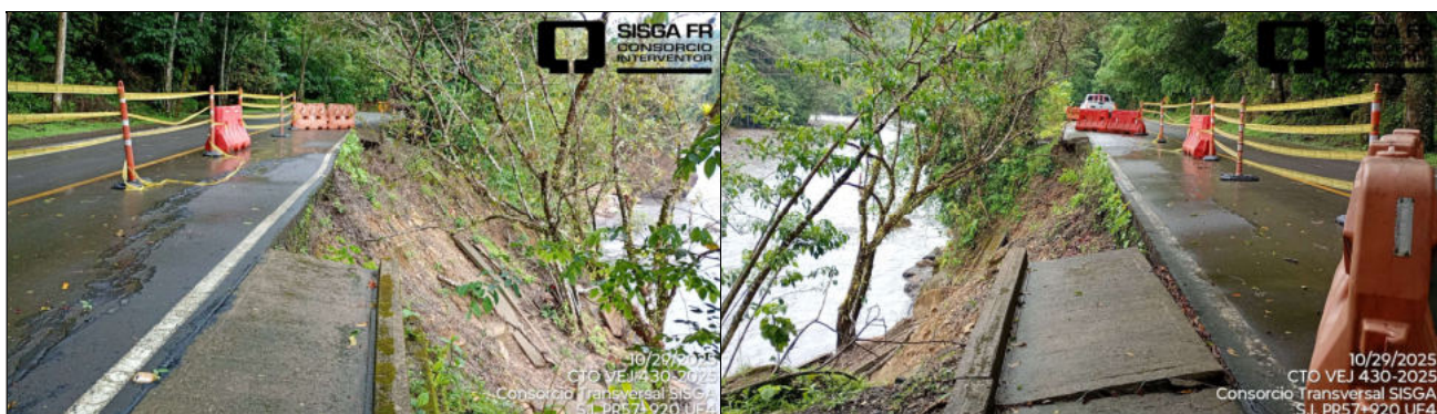
Sitio PR57+840 al PR57+920 Ruta 5608. Unidad Funcional 4. Se presenta erosión en talud inferior y pérdida de soporte de la cuneta, debido a creciente súbita del río Lengupá. No relacionado en el Apéndice Técnico 1.
