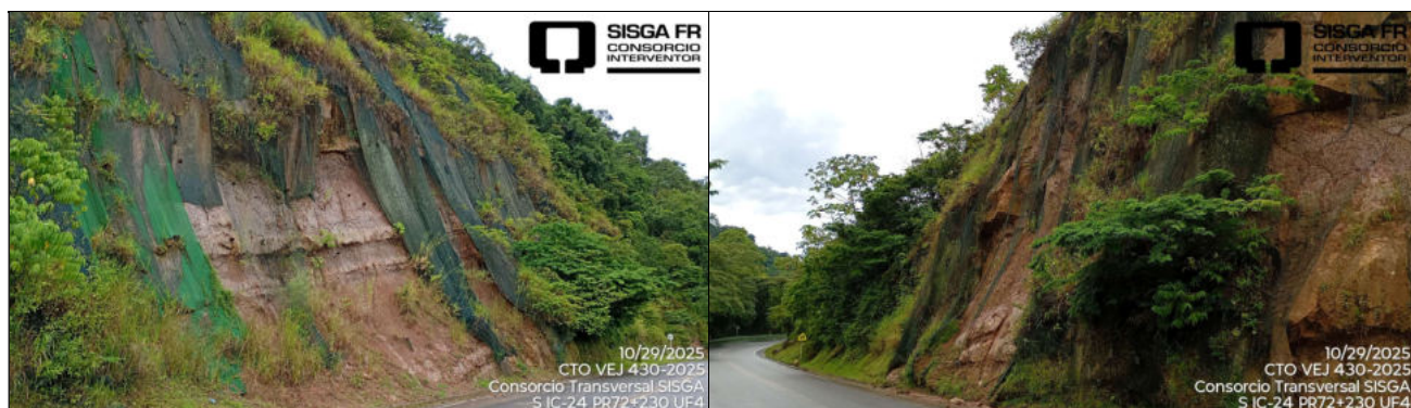
Sitio Contractual IC-24 – PR72+230. Ruta 5608. Unidad Funcional 4. En la ilustración anterior se observan zonas sin manto para control de erosión, zonas con el manto, la malla triple torsión y pernos sueltos.
