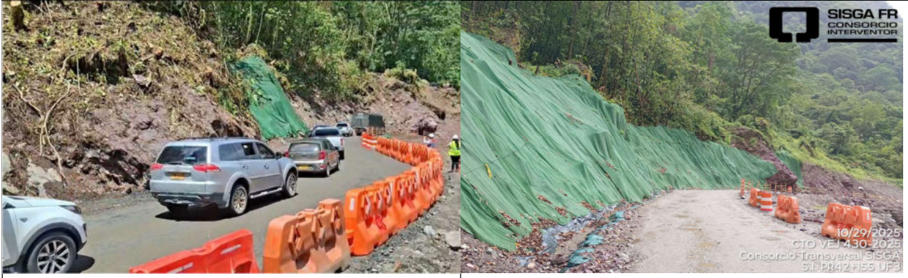
PR42+020. Sitio Inestable. Ruta 5608. Unidad Funcional 3. Paso vehicular restringido a un carril con capacidad de 16 Tn
