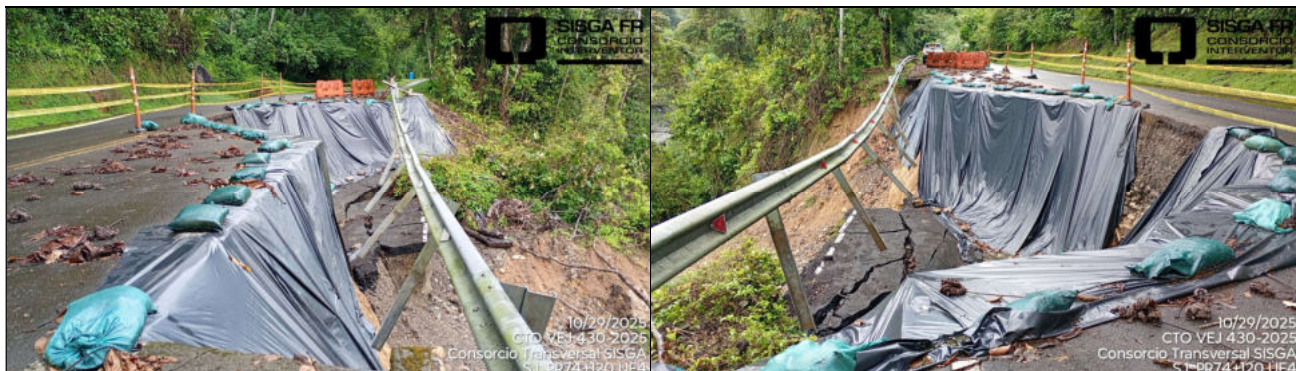
Sitio PR74+080 al PR74+120 Ruta 5608. Unidad Funcional 4. Se presenta pérdida de la banca, debido a creciente súbita del río Lengupá. No relacionado en el Apéndice Técnico 1.
