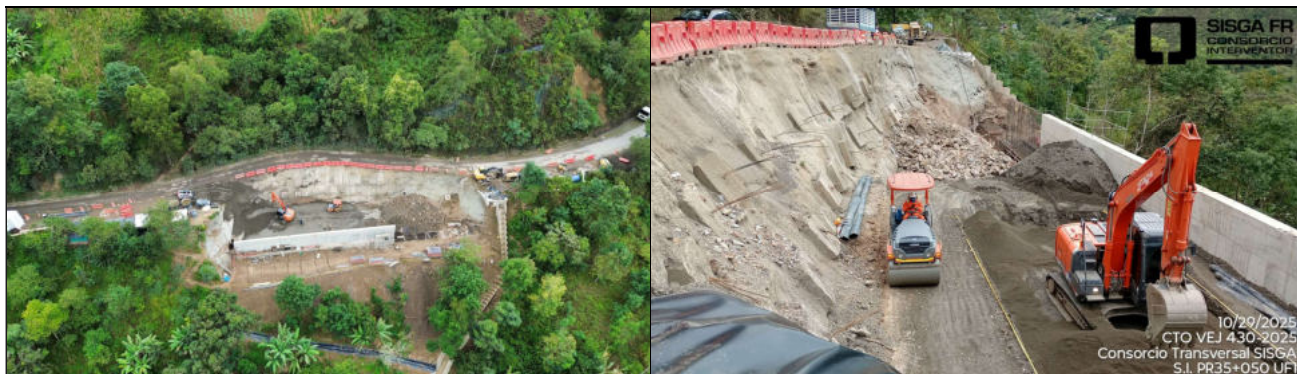
Sitio PR35+050. Ruta 5607. Unidad Funcional 1. Pérdida de la banca. Paso controlado a un carril. control vial 24 horas. En construcción obras para la recuperación de la banca y solución del Sitio Inestable.
