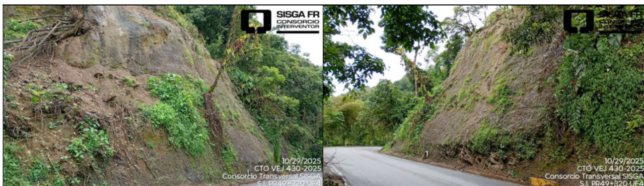
Sitio PR49+320 Ruta 5608. Unidad Funcional 4. Inestabilidad generada por la saturación que tiene el terreno, movimiento en masa. No relacionado en el Apéndice Técnico 1.
