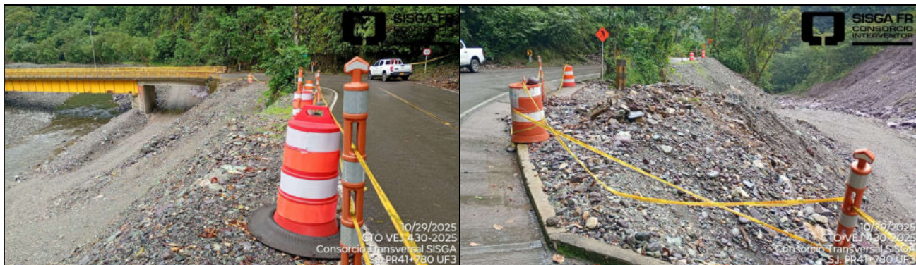
Sitio PR41+710 a PR41+780 Ruta 5608. Unidad Funcional 3. Se presenta erosión en talud inferior con pérdida de soporte de la cuneta debido a creciete súbita del río Batá. No relacionado en el Apéndice Técnico 1.
