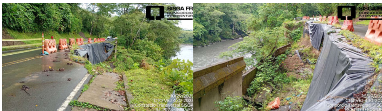
PR73+800. Sitio Crítico Ruta 5608. Unidad Funcional 4.
