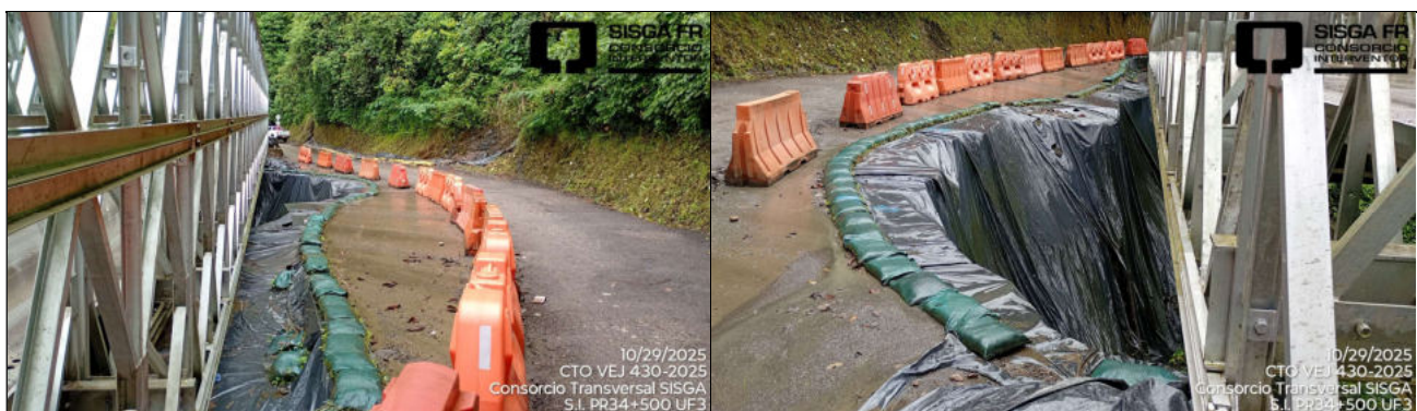
Sitio PR34+500 Ruta 5608. Unidad Funcional 3. Se presenta pérdida total de la banca debido a avenida torrencial. No relacionado en el Apéndice Técnico 1.
