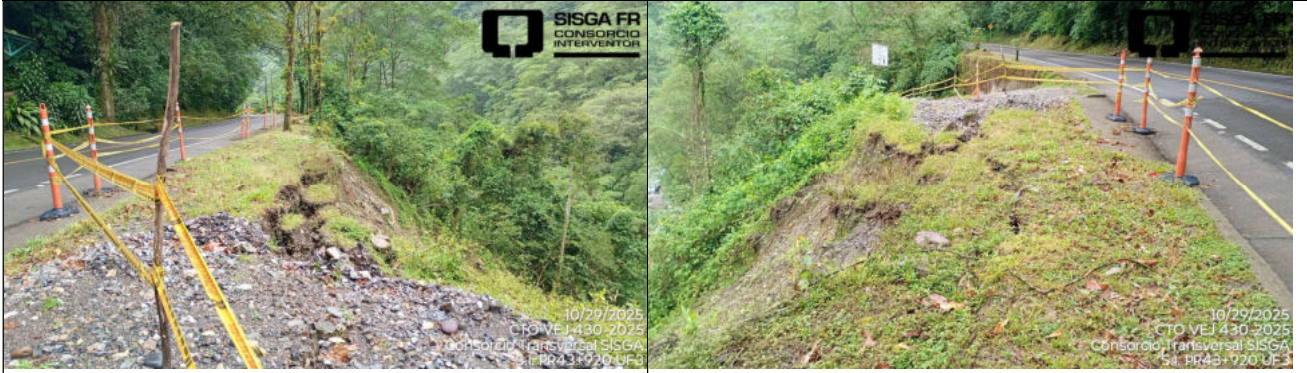
Sitio PR42+800 Ruta 5608. Unidad Funcional 3. Se presenta desconfinamiento de la vía, debido a creciente súbita del río Batá. No relacionado en el Apéndice Técnico 1.
