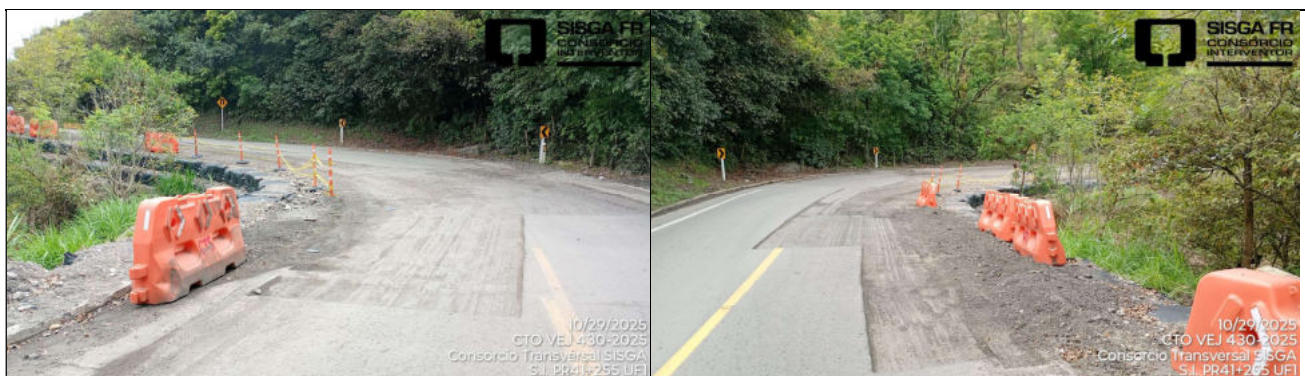
Sitio contractual PR41+255 Ruta 5607. Unidad Funcional 1. Se presenta activación de un movimiento rotacional sobre el talud inferior.
