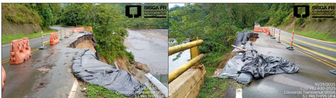
Sitio PR67+995 al PR68+000 Ruta 5608. Unidad Funcional 4. Se presenta erosión en talud inferior, debido a crecienta súbita del río Lengupá. No relacionado en el Apéndice Técnico 1.
