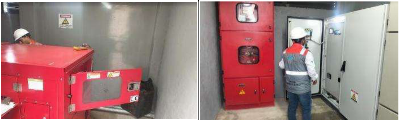
Equipos para la Operación del peaje en condiciones de falla de la energía eléctrica
