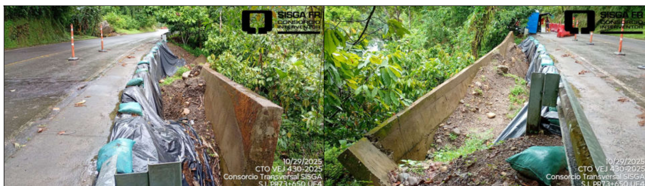
Sitio PR73+650 Ruta 5608. Unidad Funcional 4. Perdida de confinamiento de la calzada, No relacionado en el Apéndice Técnico 1.
