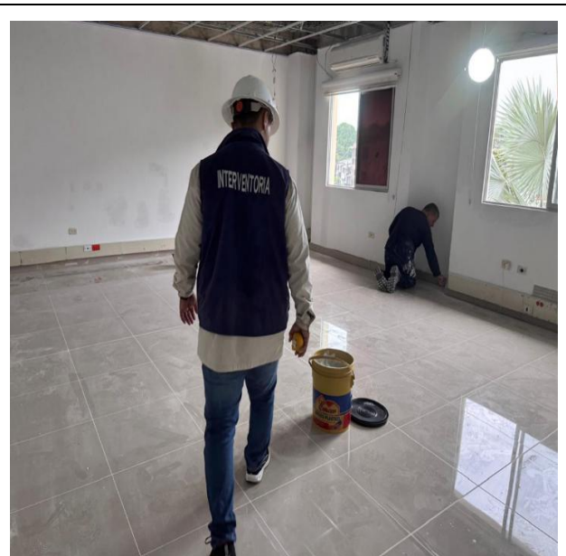
Ubicación séptima brigada, se realiza control y seguimiento en el suministro e instalación del enchape.
