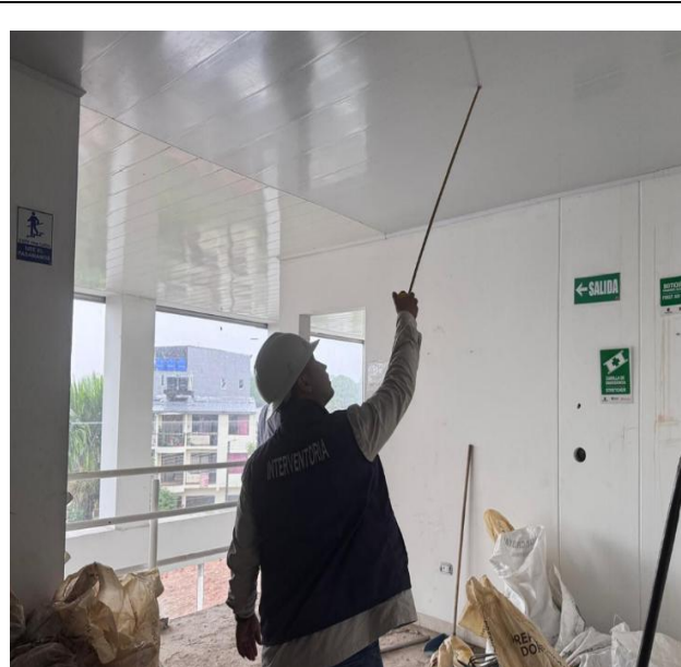
Ubicación séptima brigada, se realiza control y seguimiento en el suministro e instalación de cieloraso.
