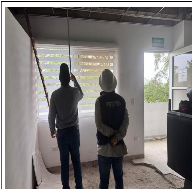
Ubicación séptima brigada, se realiza control y seguimiento en el suministro e instalación de cieloraso.
