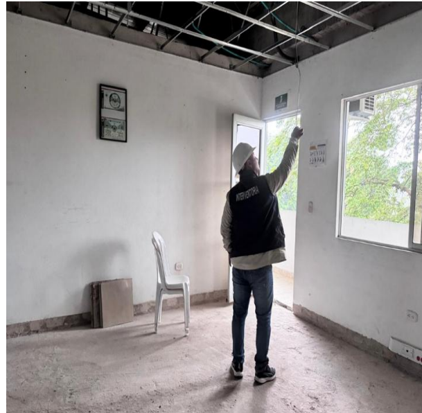
Ubicación séptima brigada, se realiza control y seguimiento en el suministro e instalación de cieloraso.
