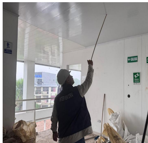
Ubicación séptima brigada, se realiza control y seguimiento en el suministro e instalación de cieloraso.
