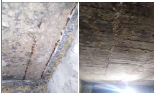
Vista de hierro corroído de los tanques subterráneo
