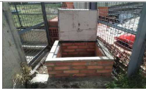
Caja de acometida principal de suministro de agua
