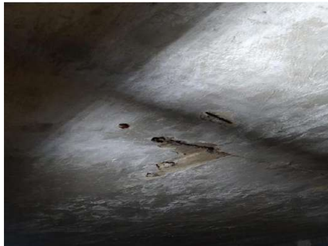
ACERO DE REFUERZO EXPUESTOS
