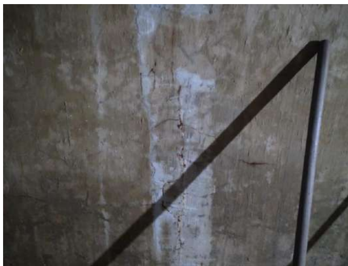
FISURAS DE PAÑETES MUROS
