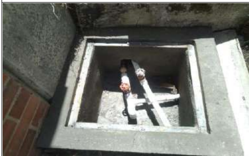
Caja de acometida principal de suministro de agua
