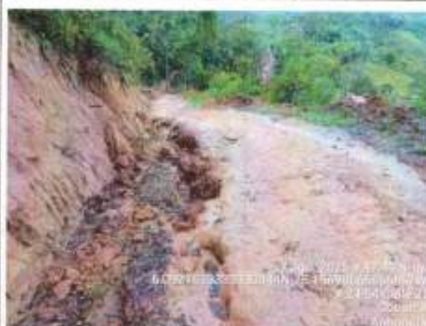
Foto No. 22: Estado de la vía por las fuertes lluvias y la alta pendiente de la vía.
