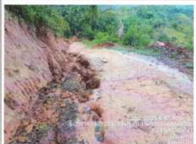
Foto No. 02: Evolución de la rasante a causa de las aguas lluvias. Estado 2, tramo # 3.
